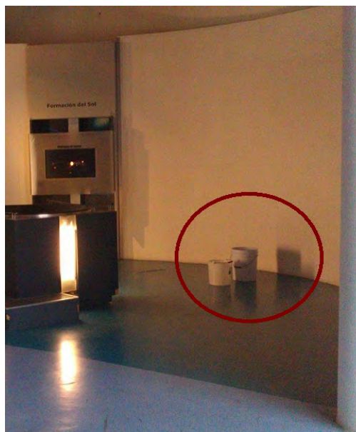
Ilustración 2.12.5 Presencia de dos cubetas para las goteras. Foto tomada por Jesús Pérez López.
