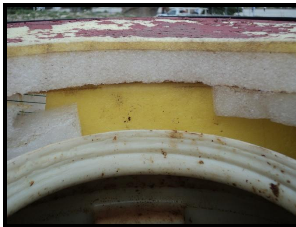
Figura 3.1. Recubrimiento del forro aislante del tanque, vista Interior lateral Superior del tanque.
