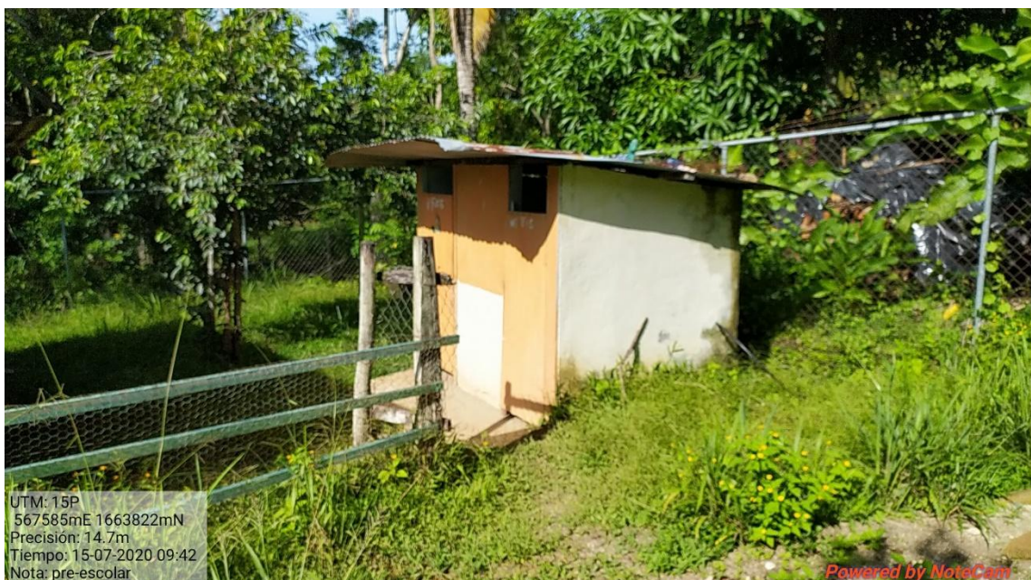
Imagen 3. Baños en mal estado del jardín de niños.
