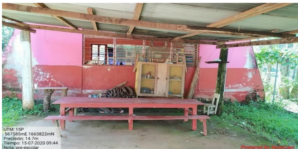
Imagen 6. Aula en deterioro en el cual tomaban clases antes los niños.
