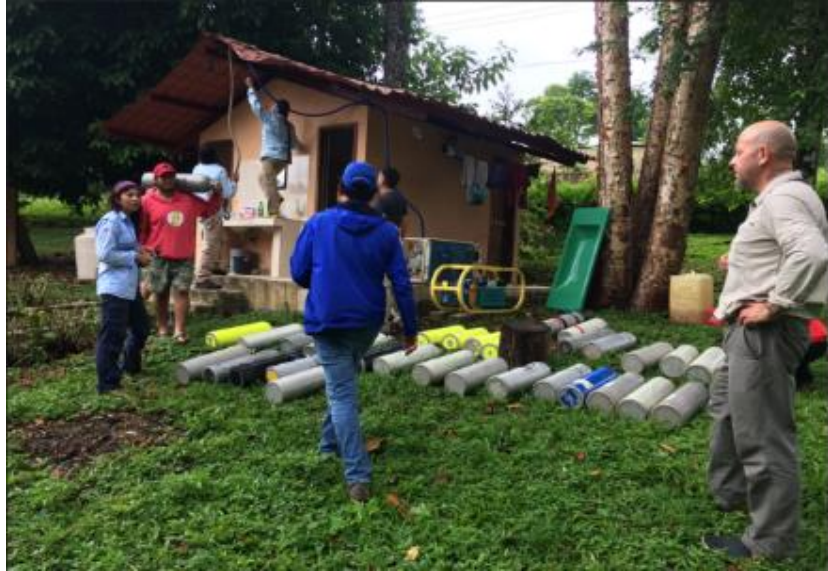
Figura N°66. Instalación de los 2 compresores. Equipo SAS, Fabio Amador y UNICACH. Fotografía tomada por: Berenice Ferra, 2018.
