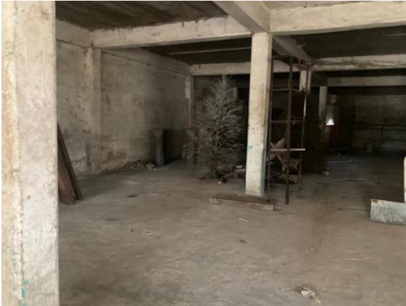
Figura 9 Área de bodega
