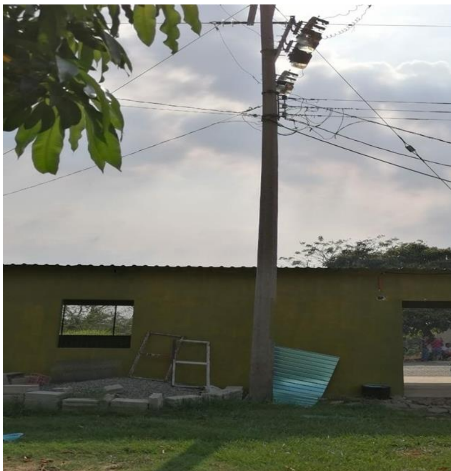
Figuras 10. Poste en Mal Estado
