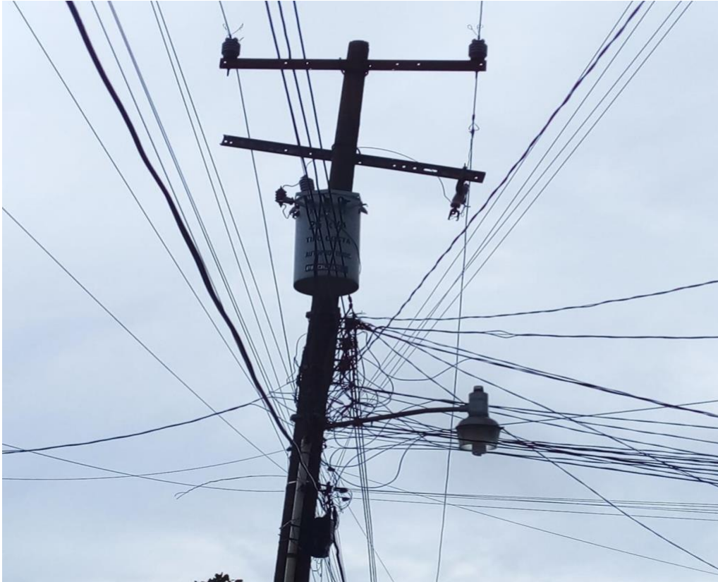
Figuras 12. Poste inclinado
