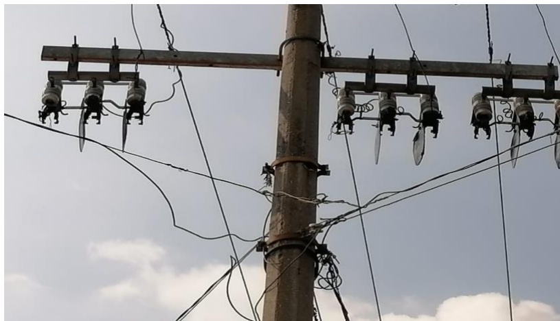
Figuras 9. Poste en mal estado
