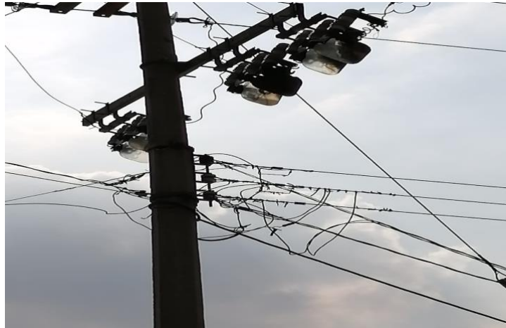
Fuente. En base a la información obtenida Figuras 8. Cables en mal estado
