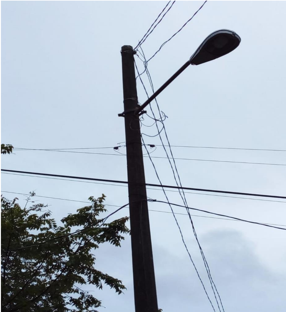
Figuras 11. Poste inclinado
