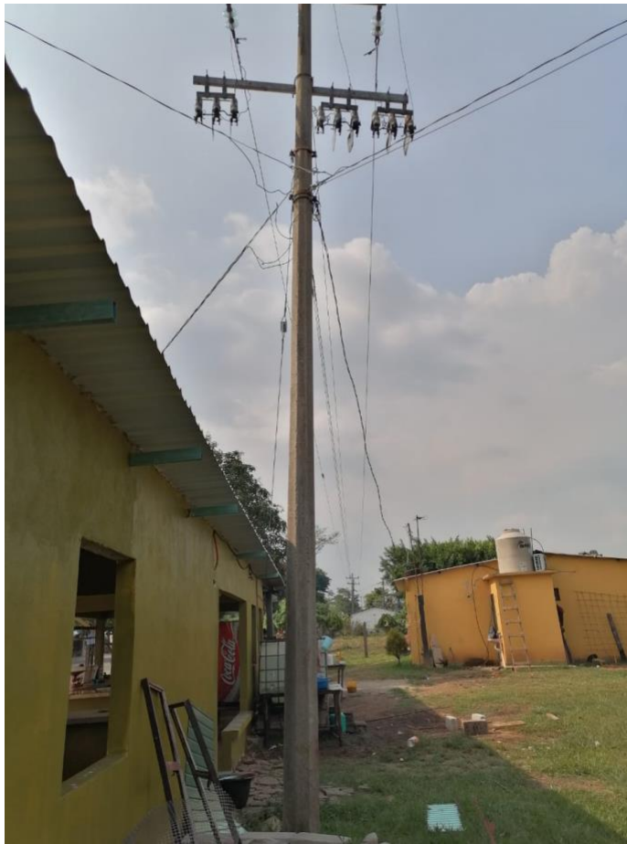
Figuras 6. Condiciones inseguras
