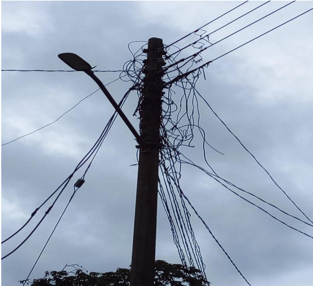
Figuras 14. Cableado empinado
