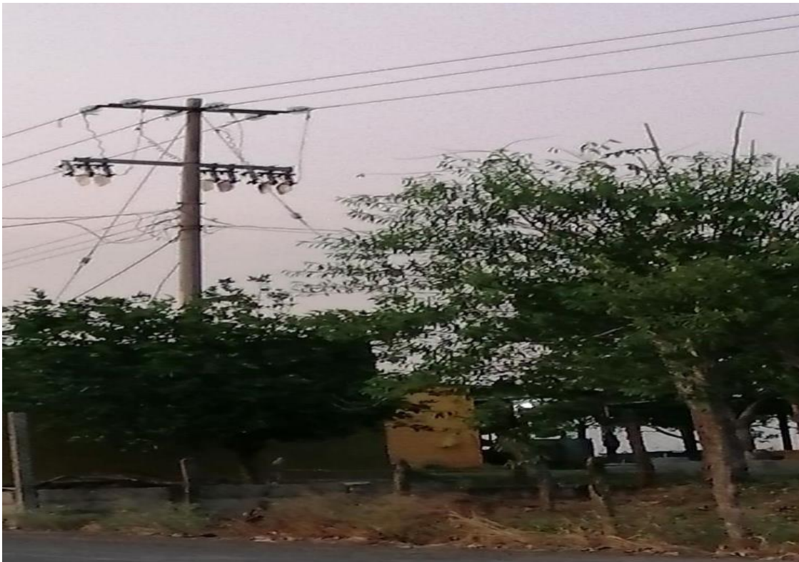
Figuras 7. Cableado que hacen que lo provoquen, ya partes quemadas.
