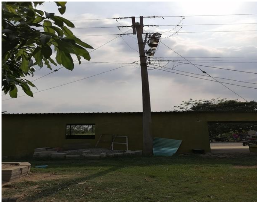
Figuras 5. Poste de luz en mal estado
