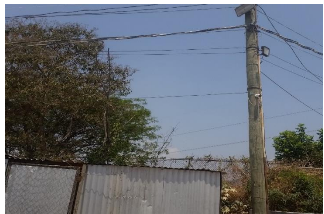
Ilustración 7 La parte de arriba del ATRP hay cables de alta tensión.
