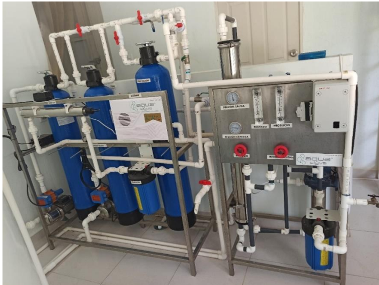
Figura 11. Proceso de purificación de agua de la purificadora A
