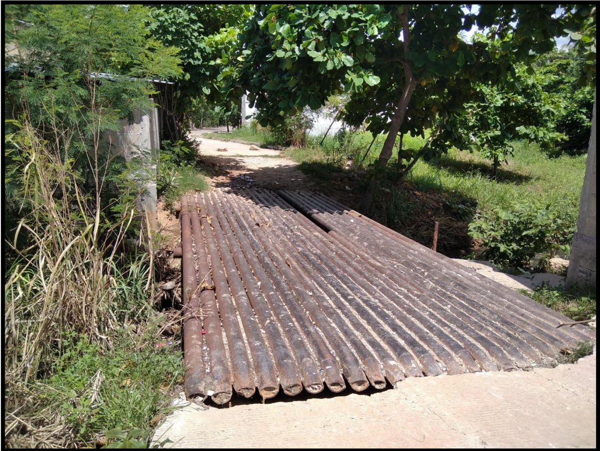
Figura 17. Puente mal cimentado
