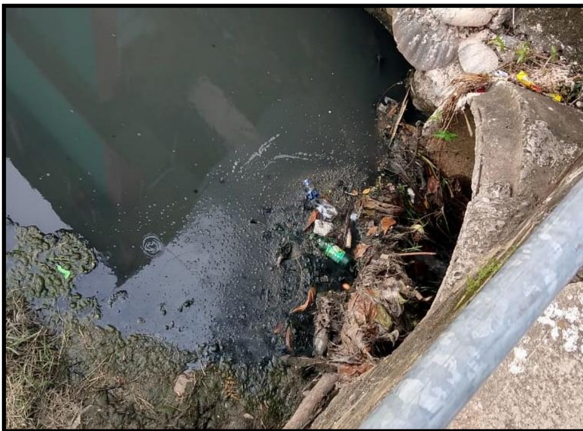
Figura 13. Exceso de residuos sólido
