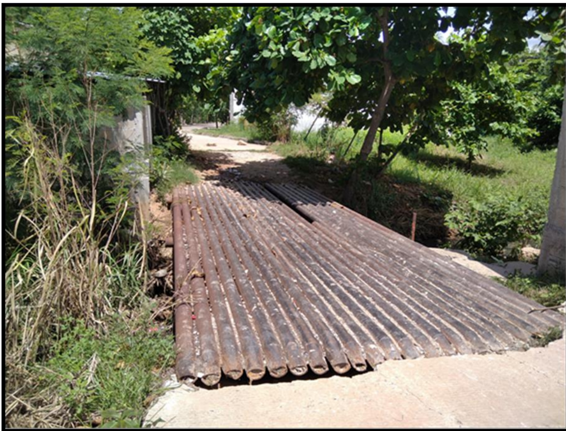
Figura 11. Puente en mal estado
