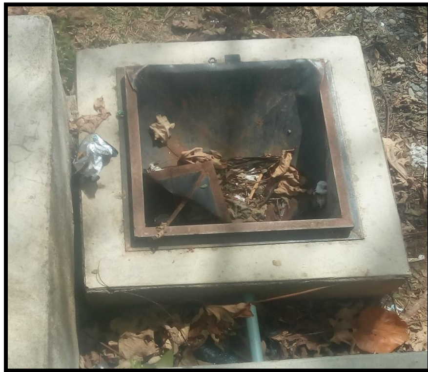
Ilustración 10. Caja eléctrica en mal estado Fuente: Con base a la información obtenida
