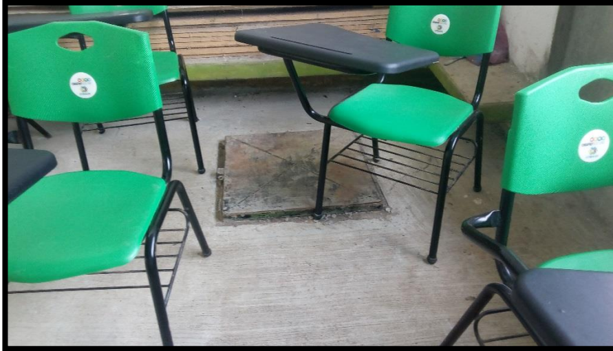
Ilustración 9. Edificio B, salón con caja eléctrica Fuente: Con base a la información obtenida
