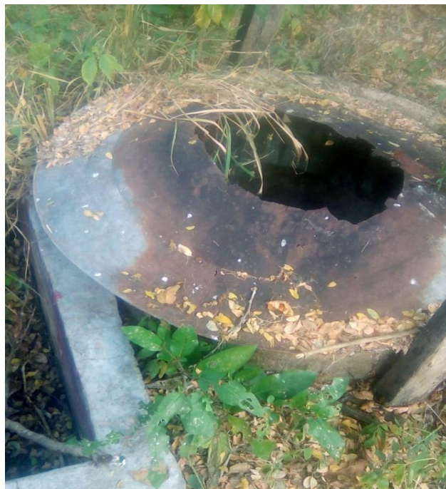
Imagen 15 Pozo de agua. Fuente propia.
