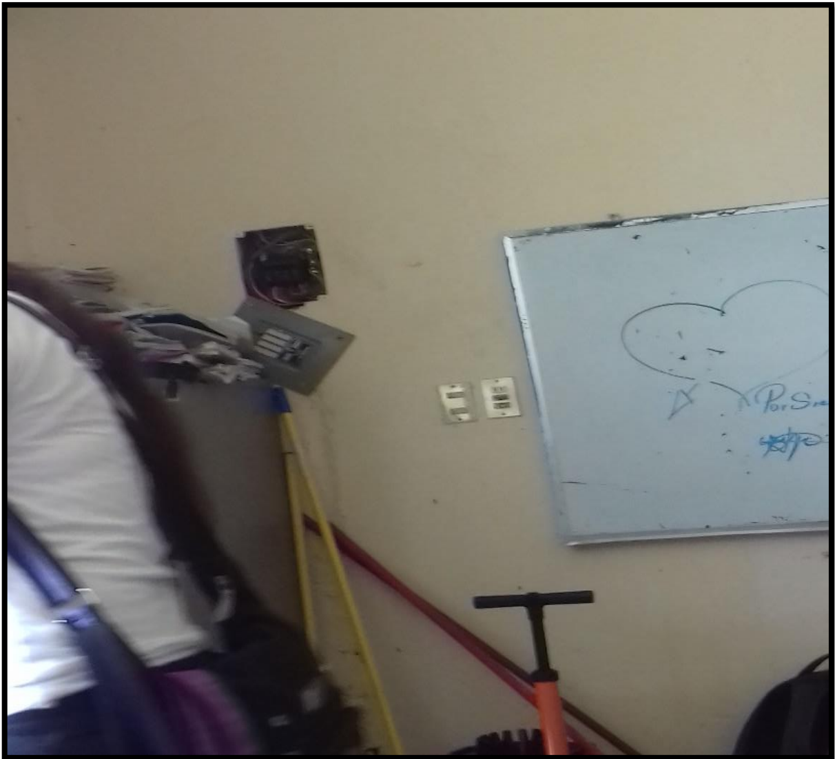
Figura. 20 Instalaciones eléctricas deterioradas por falta de mantenimiento
