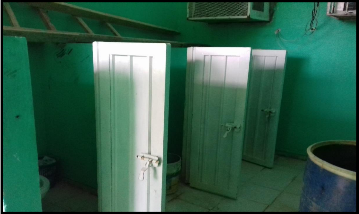
Figura. 24 Uso de lo sanitarios como bodega improvisada. Riesgo de caída de la escalera.
