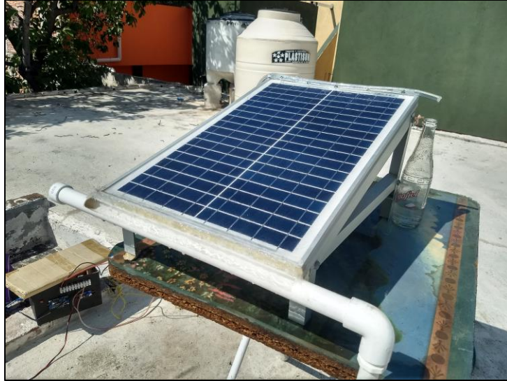
Figura 4.21 Módulo fotovoltaico con técnica de enfriamiento y limpieza.
