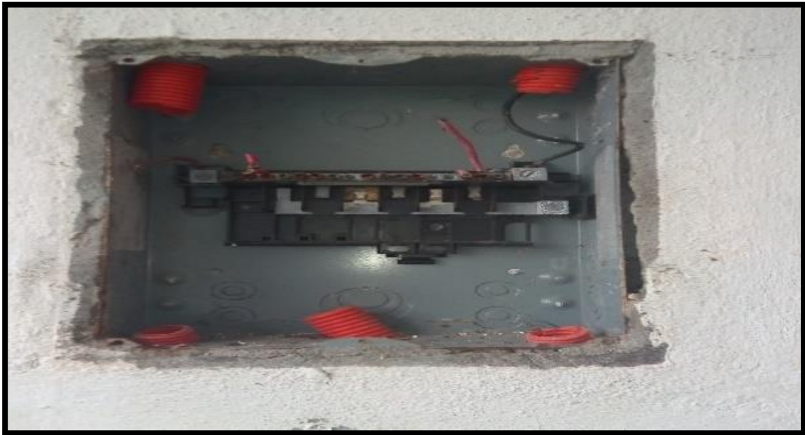
FIGURA 21 Caja de registro eléctrico
