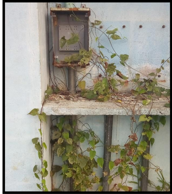
FIGURA 31 Cajas de registro
