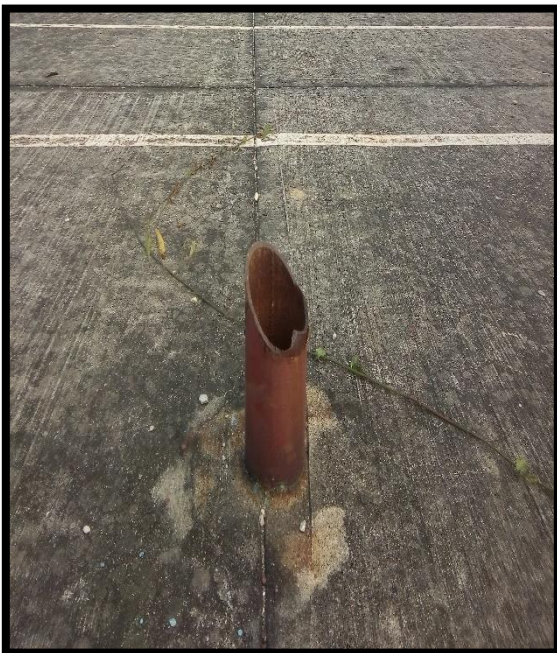
FIGURA 32 Restos de tubería
