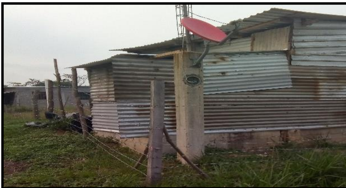
FIGURA 24 Mufas sin medidor
