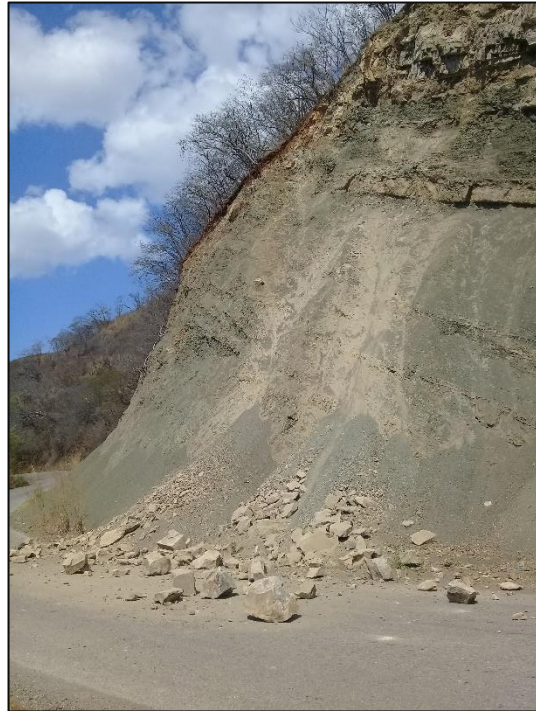
Figura No. 49. -Talud No 15, Caídos; (Fuente: Propia)
