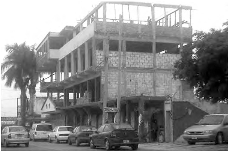
Figura 20. Irregularidad de un edificio que se emplea como oficinas del Instituto Federal Electoral en la ciudad de Tuxtla Gutiérrez.
