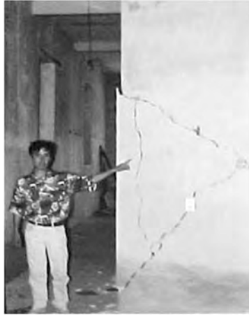
Figura 16. Daños en mampostería sin refuerzo, debidas al comportamiento frágil del muro para esfuerzos de tensión y corte (fotografía del maestro Raúl Vera Noguez).
