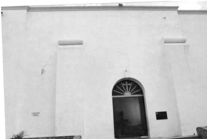
Figura 23a. Daños en estructuras de iglesias y centros de culto. Daños en una cúpula y muros de la catedral de San Marcos en Tuxtla Gutiérrez (fotografías cortesía del ingeniero José Alfredo Chan).
