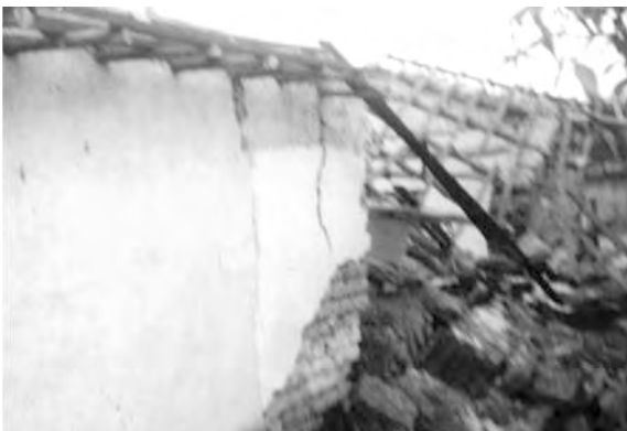
Figura 3b. Daño en estructuras de adobe en la población de Nuevo México, municipio de Villaflores (fotografías cortesía del ingeniero José Alfredo Chan).
