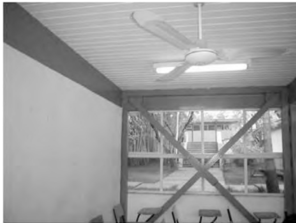
Figura 25a. Posterior al sismo la mayoría de las estructuras de escuelas fueron reforzadas con diagonales, al igual que los edificios de la facultad de ingeniería de la UNACH.
