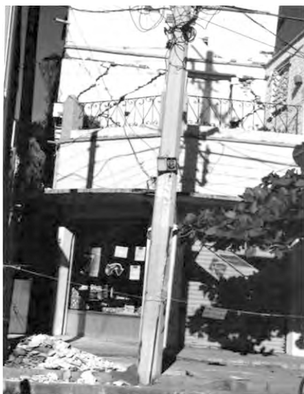
Figura 6. Daños en la cabecera municipal de Villaflores (fotografía cortesía del ingeniero José Alfredo Chan).
