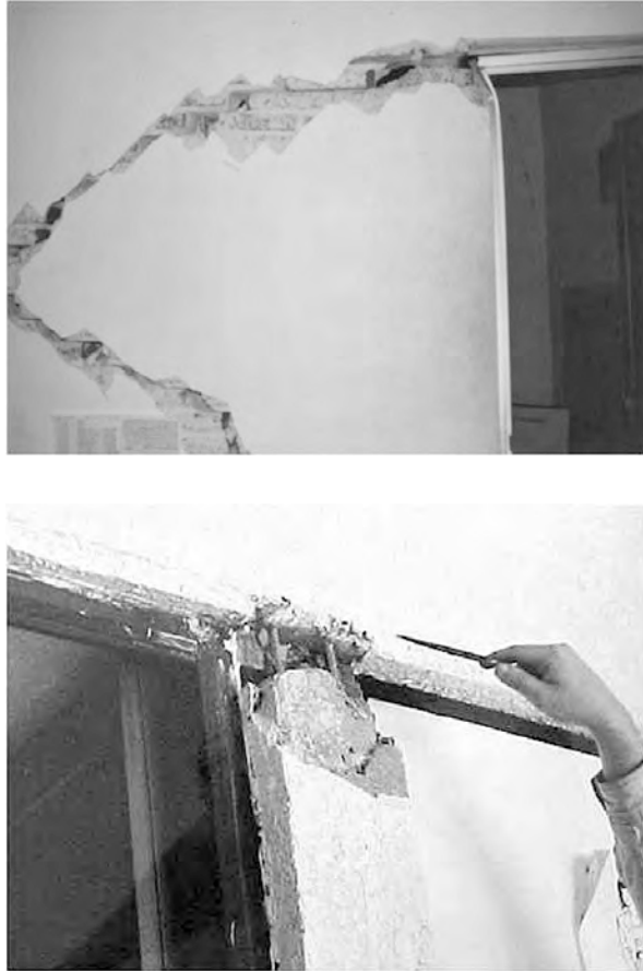
Figura 7. Daños en la presidencia municipal de Villaflores (fotografías cortesía del ingeniero José Alfredo Chan y del maestro Raúl Vera Noguez).
