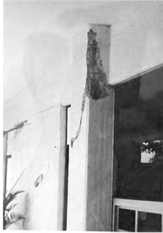
Figura 26b. Daños en muros y columnas del edificio de rectoría de la UNACH (fotografías cortesía del maestro Jorge Alfredo Aguilar Carboney).
