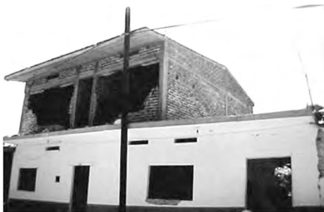
Figura 8. Daños en vivienda de mampostería confinada en la cabecera municipal de Villaflores (fotografía cortesía del maestro Raúl Vera Noguez).
