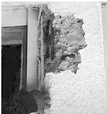
Figura 21. Una de las fallas más comunes en estructuras de concreto es la separación de los estribos, ya que genera una falta de confinamiento (fotografías cortesía del maestro Raúl Vera Noguez).
