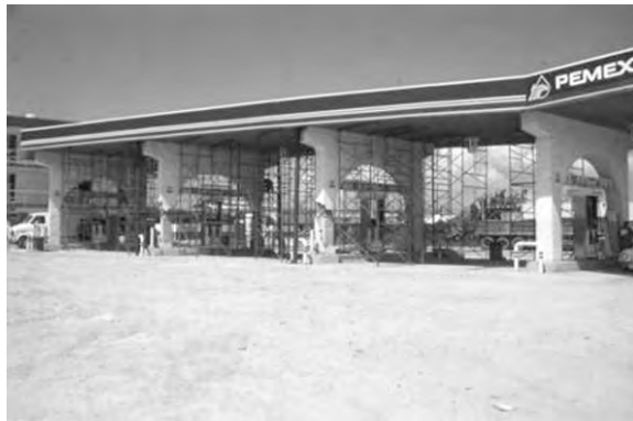
Figura 7a. Daño observado en una gasolinera de Manzanillo. Una estructura similar contigua colapsó.
