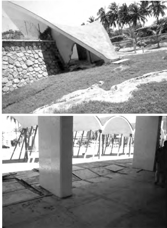
Figura 3. Daños debido a licuación de arenas en las instalaciones de la Unidad Médica Familiar UMF-2 del IMSS.
