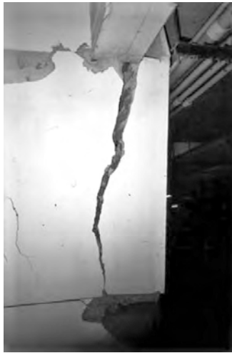
b) Falla de muro en el sótano.
