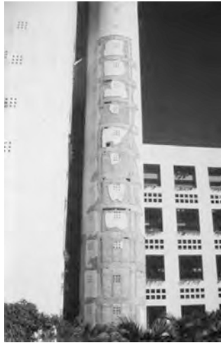
Figura 33. Daño no estructural en el cubo de escaleras del hotel Westin Regina (foto cortesía de Eduardo Miranda).
