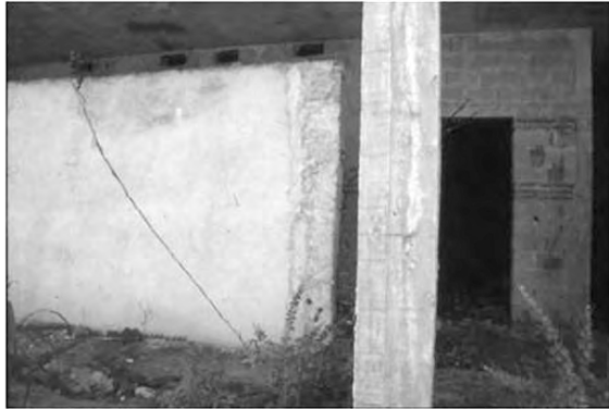
Figura 12b. Daño observado en la obra negra de la autoconstrucción que irresponsablemente pretendía ser un hospital privado en las afueras de Manzanillo.
