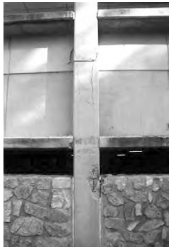
Figura 21a. Daño en columnas del sótano del edificio principal del HGZ-10 del IMSS.
