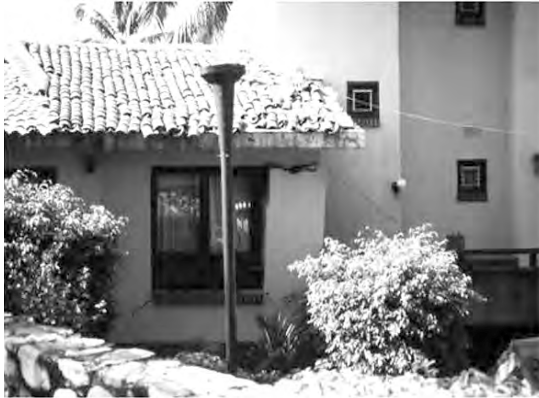
Figura 10a. Daños típicos observados en estructuras de mampostería no confinada del conjunto plaza Las Glorias.
