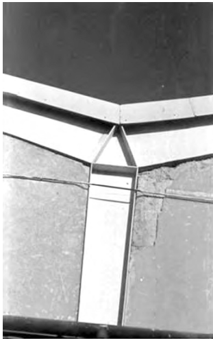
a) Daño en el muro .
