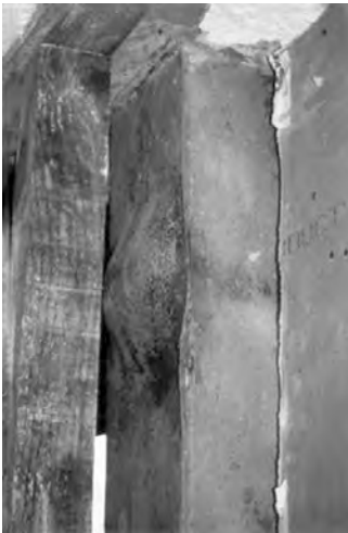
Figura 31. Vistas generales del daño presentado en el hotel Vidafel por su gran flexibilidad lateral (fotos cortesía de Óscar de la Torre Rangel).
