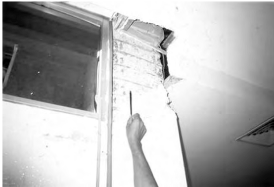
Figura 22. Daño en columna C-7 del edificio principal por efecto de columna corta.
