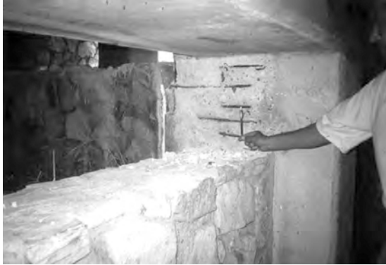
Figura 21b. Daño en columnas del sótano del edificio principal del HGZ-10 del IMSS.
