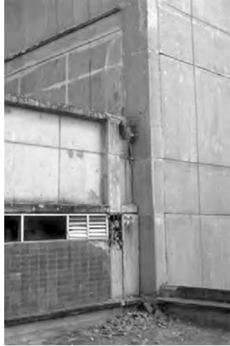
Figura 23b. Daños ocasionados por el choque estructural entre el edificio principal y el anexo.
