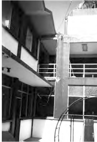
a) Por asentamientos diferenciales.
