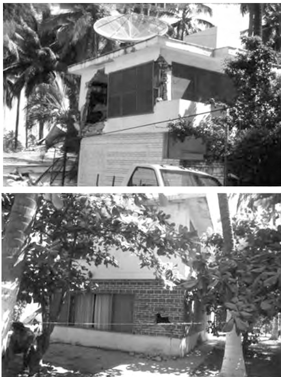
Figura 11. Casas de veraneo cercanas al extinto hotel Costa Real seriamente dañadas debido a su deficiente o nulo confinamiento.
