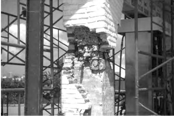
Figura 7b. Daño observado en una gasolinera de Manzanillo. Una estructura similar contigua colapsó.
