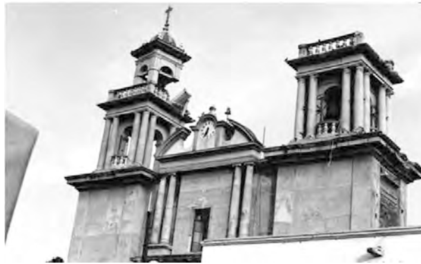
b) Daño en las torres de la iglesia principal de Armería, Colima.
