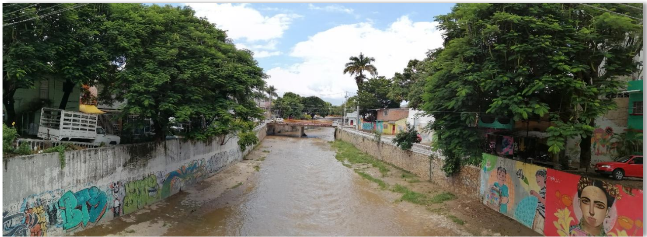
Mismo puente de la Calle Central entre 4 a Norte Poniente y 5 Av. Norte, foto tomada hacia el lado poniente. Foto 179.
