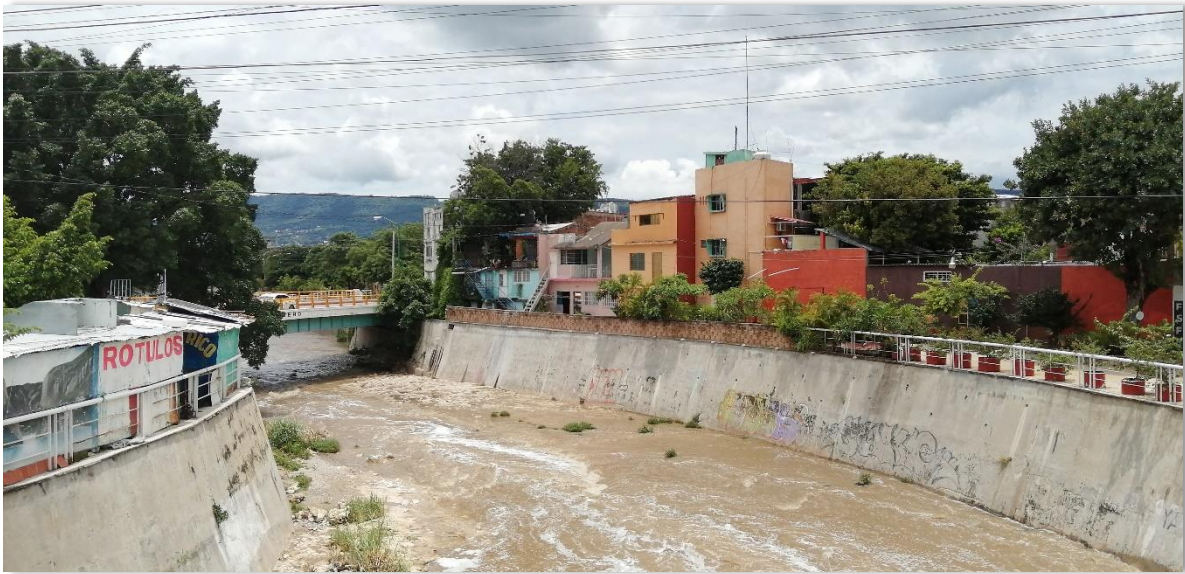
2 puente en la 4ª Norte Oriente entre 5ª y 6ª Oriente Norte, al fondo se puede apreciar El Zapotal/Cerro Hueco. Foto 168.
