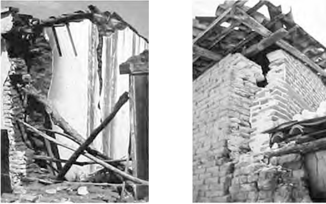
Figura 2b. Daños en estructuras de adobe donde la poca resistencia del material y el efecto del diafragma flexible causa daños muy importantes (fotografías cortesía de Raúl Vera Noguez).
