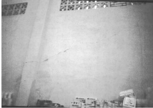
b) Daño en castillo de un muro sin dalas.
