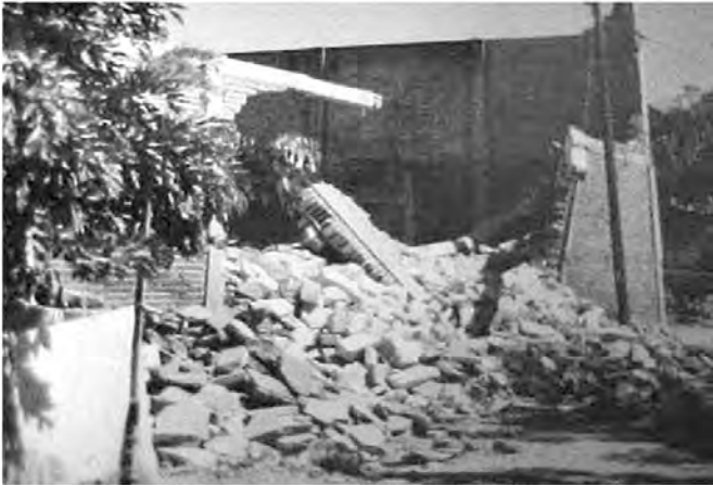
Figura 11. Daños en muros de mampostería confinada mal detallada (fotografía cortesía de Raúl Vera Noguez).
