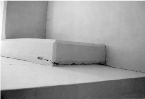
Figura 18b. Daños en estructura de concreto y mampostería del Palacio de gobierno en la ciudad de Tuxtla Gutiérrez (fotografías cortesía de ingeniero José Alfredo Chan).
