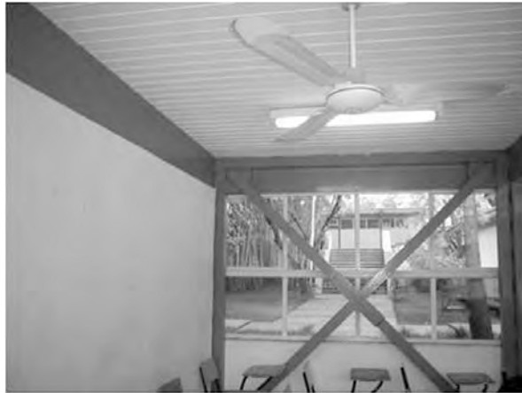
Figura 25a. Posterior al sismo la mayoría de las estructuras de escuelas fueron reforzadas con diagonales, al igual que los edificios de la facultad de ingeniería de la UNACH.
