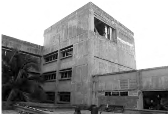
Figura 23a. Daños ocasionados por el choque estructural entre el edificio principal y el anexo.
