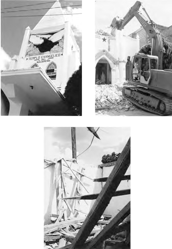
Figura 9. Daños y demolición de la iglesia del Nazareno, Villaflores, Chiapas (fotografías cortesía del ingeniero José Alfredo Chan).
