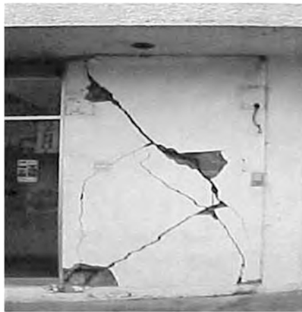
Figura 17b. Estructura de mampostería confinada en la ciudad de Tuxtla Gutiérrez (fotografías cortesía de maestro Raúl Vera Noguez).
