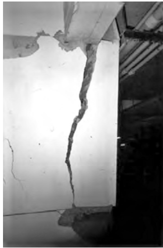
b) Falla de muro en el sótano.
