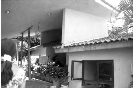
Figura 10b. Daños típicos observados en estructuras de mampostería no confinada del conjunto plaza Las Glorias.
