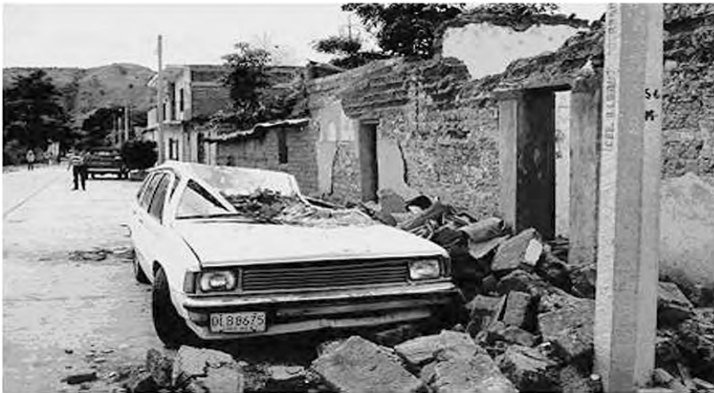
Figura 3. Daños en estructuras de José María Garza, municipio de Villaflores (fotografía cortesía del ingeniero José Alfredo Chan).
