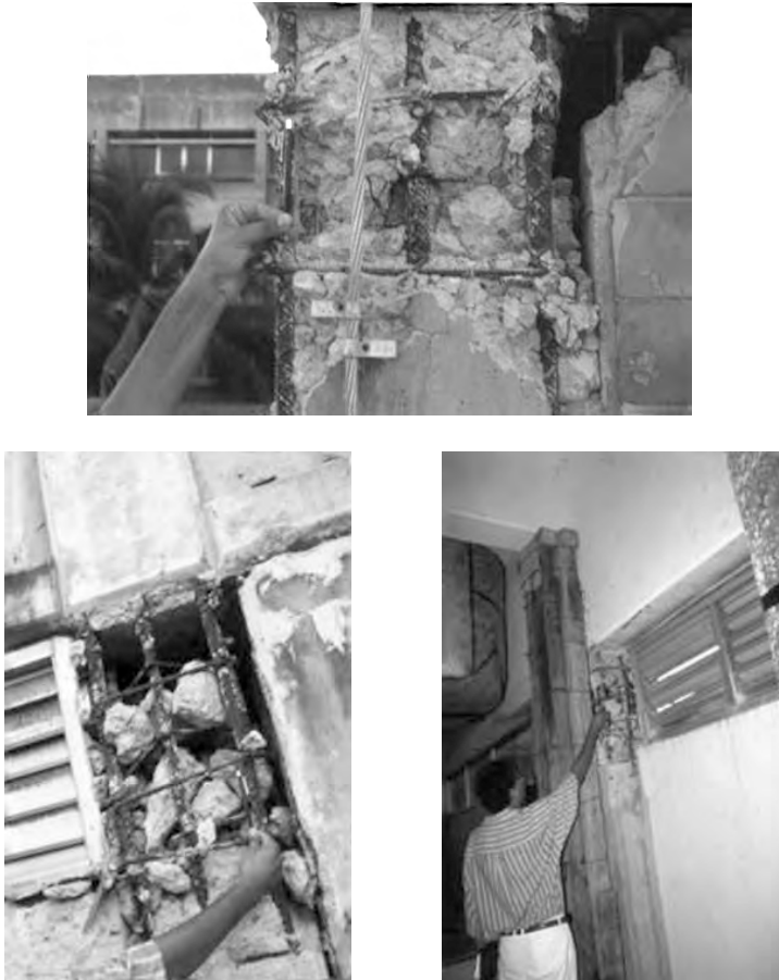
Figura 25. Columnas cortas en el edificio anexo del HGZ-10.
