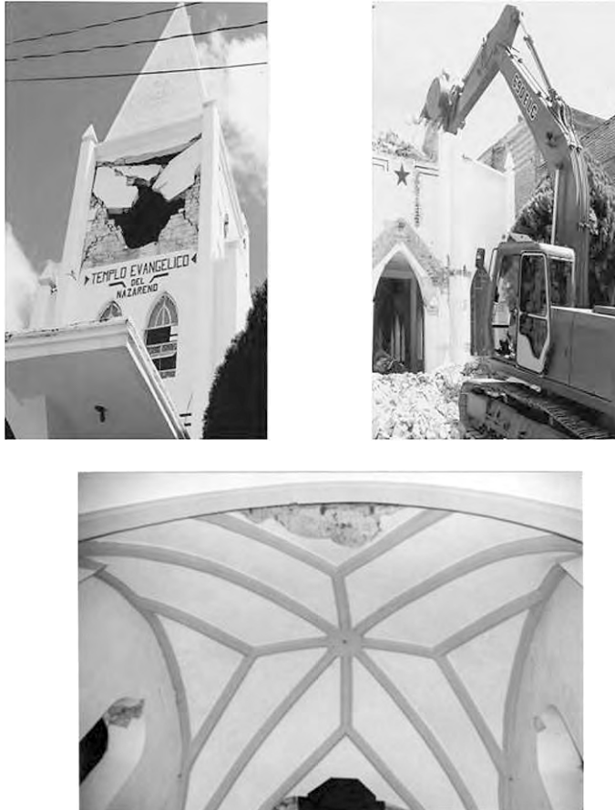
Figura 4. Daños en estructuras de iglesias y centros de culto. Las primeras dos fotografías corresponden a una iglesia en Nuevo México, municipio de Villaflores y la tercera muestra daños en una cúpula de la catedral de San Marcos en Tuxtla Gutiérrez (fotografías cortesía de ingeniero José Alfredo Chan Chin).
