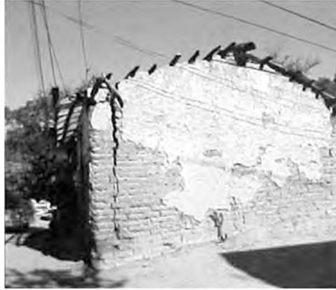
Figura 1c. Daños en estructuras de adobe donde la poca resistencia transversal y diafragma flexible generaron la separación de los muros (fotografías cortesía de Raúl Vera Noguez).
