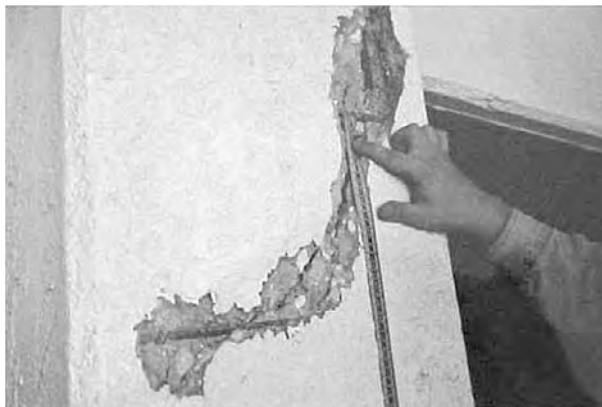
Figura 5. Daños en columnas.
