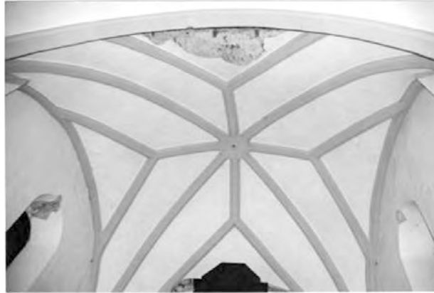
Figura 23b. Daños en estructuras de iglesias y centros de culto. Daños en una cúpula y muros de la catedral de San Marcos en Tuxtla Gutiérrez (fotografías cortesía del ingeniero José Alfredo Chan).
