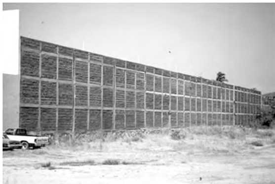
Figura 8b. Comportamiento excelente de la bodega de la Cervecería Modelo, estructurada con base en mampostería confinada conforme a las NTCM.
