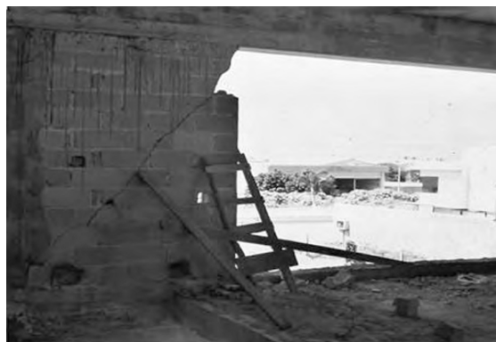
Figura 12a. Daño observado en la obra negra de la autoconstrucción que irresponsablemente pretendía ser un hospital privado en las afueras de Manzanillo.
