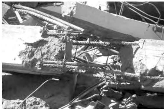
Figura 28a. Evidencia del armado original de las columnas del hotel Costa Real.
