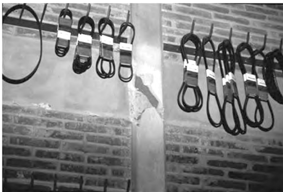
a) Daño en castillo falso en un taller mecánico.
