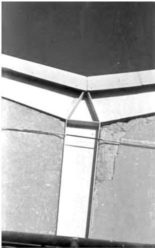
a) Daño en el muro .
