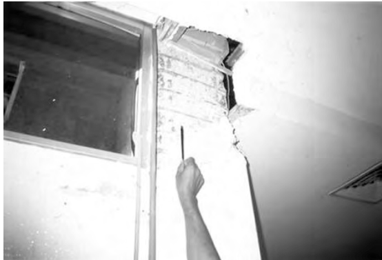
Figura 22. Daño en columna C-7 del edificio principal por efecto de columna corta.
