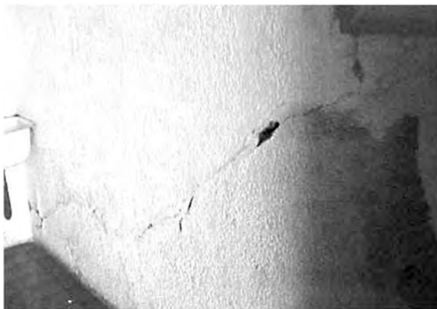
Figura 26a. Daños en muros y columnas del edificio de rectoría de la UNACH (fotografías cortesía del maestro Jorge Alfredo Aguilar Carboney).
