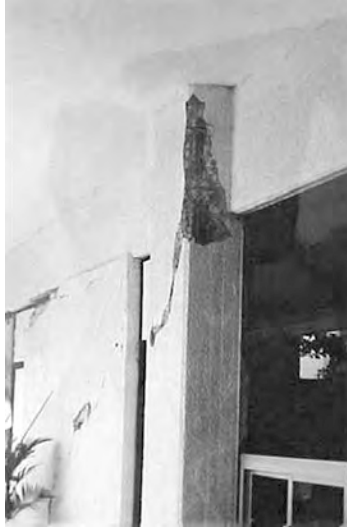
Figura 4. Daños en columna con pretil superior.
