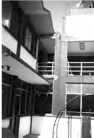
a) Por asentamientos diferenciales.
