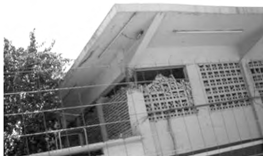
Figura 6. Columnas cortas en el edificio de la terminal de autobuses de Manzanillo.
