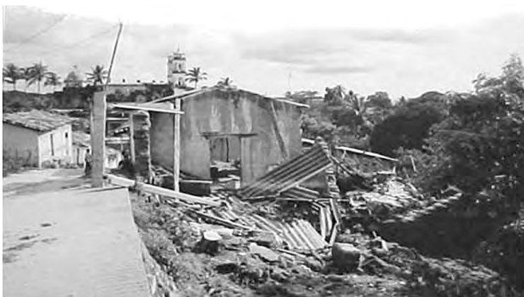
Figura 3. Colapso de estructura por no considerar las condiciones naturales del terreno al momento de diseñar la cimentación (fotografía cortesía de Raúl Vera Noguez).
