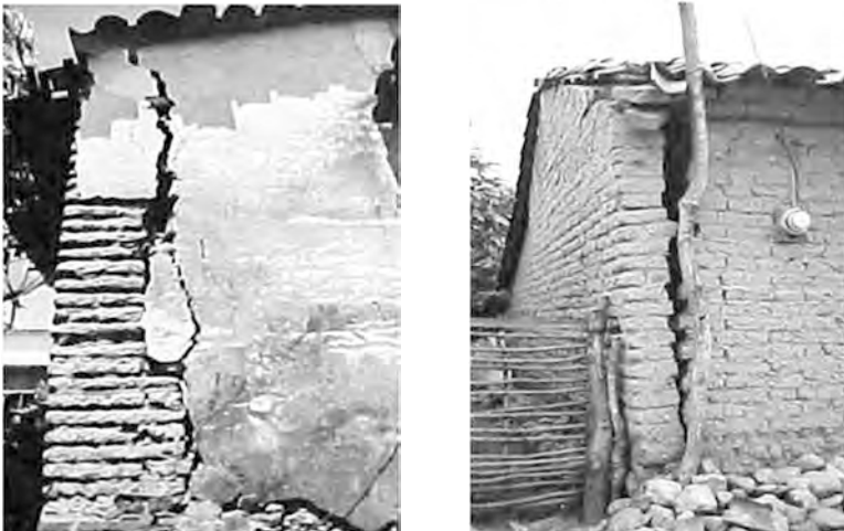
Figura 1a y b. Daños en estructuras de adobe donde la poca resistencia transversal y diafragma flexible generaron la separación de los muros (fotografías cortesía de Raúl Vera Noguez).
