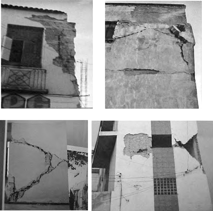
Figura 9. Daños en muros de mampostería sin refuerzo (fotografía cortesía de Raúl Vera Noguez).
