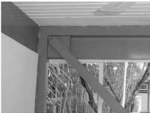
Figura 25b. Posterior al sismo la mayoría de las estructuras de escuelas fueron reforzadas con diagonales, al igual que los edificios de la facultad de ingeniería de la UNACH.
