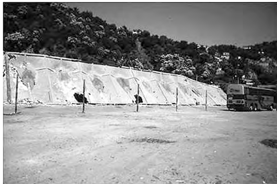
Figura 5a. Colapso del paraguas de la terminal de autobuses de Manzanillo.
