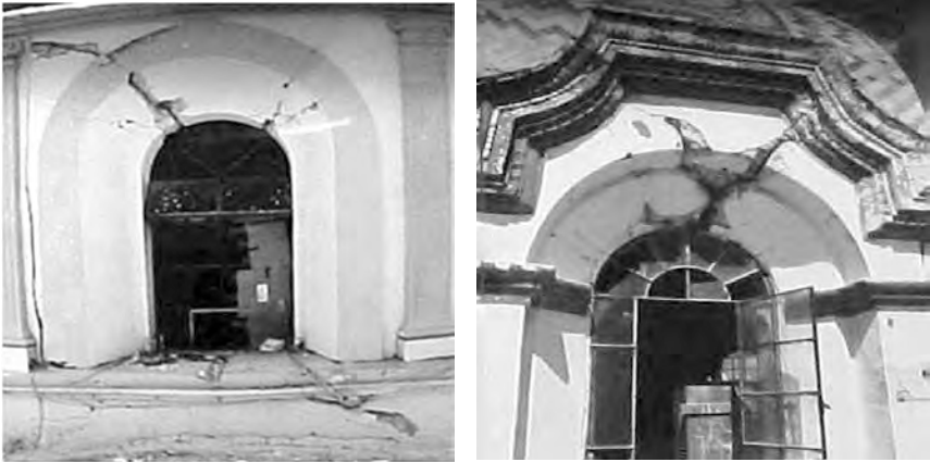
Figura 6. Daños en estructuras de iglesias en sus muros de mampostería sin refuerzo y/o adobe (fotografía cortesía de Raúl Vera Noguez).
