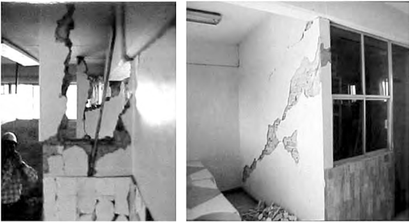
Figura 8. Daños en muros de mampostería, los cuales se vincularon indebidamente a la estructura (fotografía cortesía de Raúl Vera Noguez).
