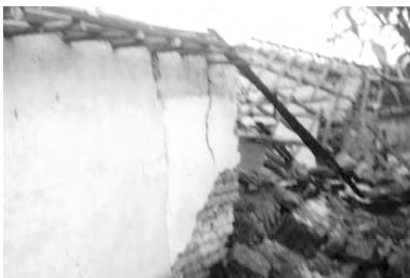
Figura 3b. Daño en estructuras de adobe en la población de Nuevo México, municipio de Villaflores (fotografías cortesía del ingeniero José Alfredo Chan).
