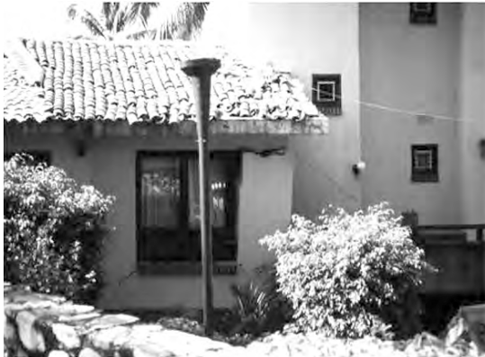
Figura 10a. Daños típicos observados en estructuras de mampostería no confinada del conjunto plaza Las Glorias.
