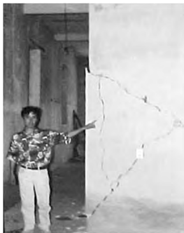
Figura 16. Daños en mampostería sin refuerzo, debidas al comportamiento frágil del muro para esfuerzos de tensión y corte (fotografía del maestro Raúl Vera Noguez).
