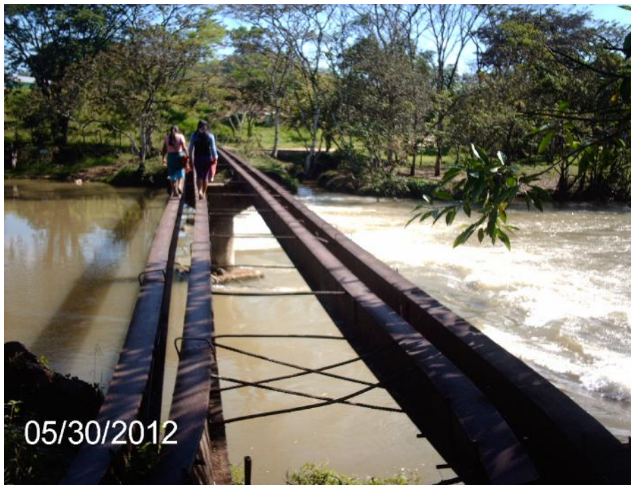
Foto 5. Puente en ruinas entre Nueva Poza y Nuevo Huixtán.
