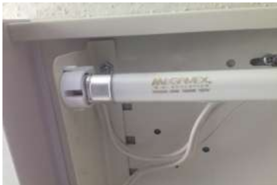
Imagen 4.2.3A Lámpara fluorescente en edificio taller, CIDTER.
