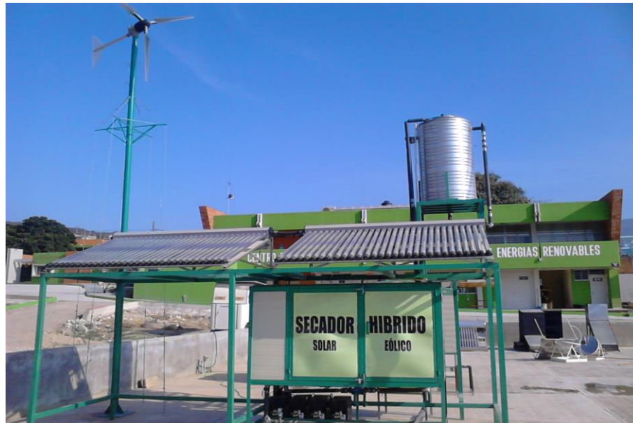
Figura A1. Imagen de la vista frontal del sistema híbrido termosolar eólico.
