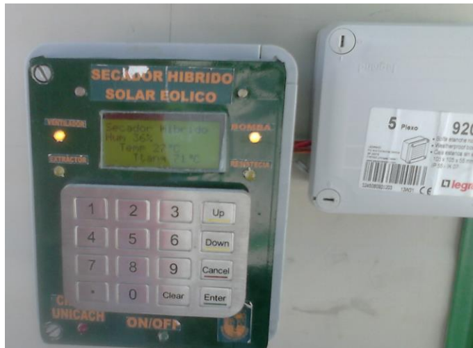
Figura 3.6. Sistema de medición y control.
