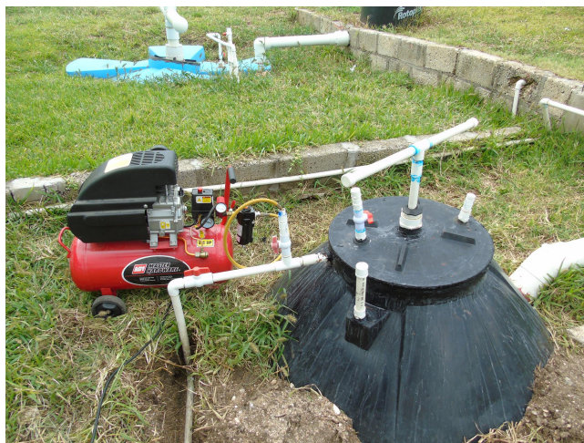
Figura A.1: Detección de fugas en el biodigestor.
