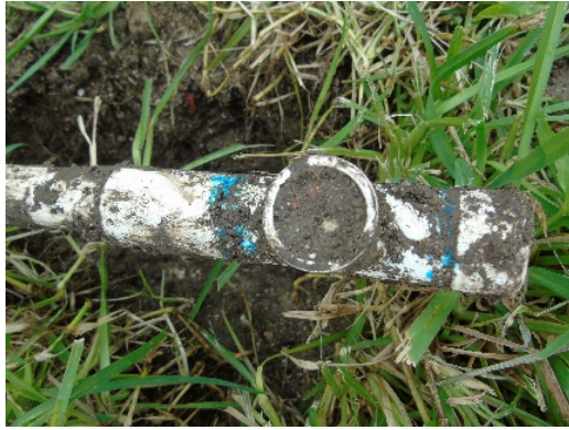
(a) Obstruida de lodo
