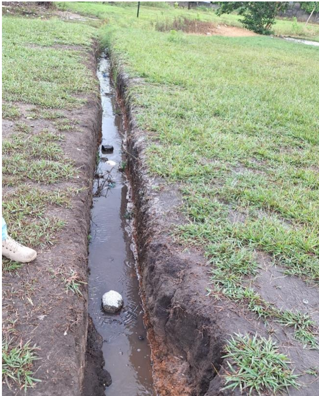
Figura 9 Zanja de agua
