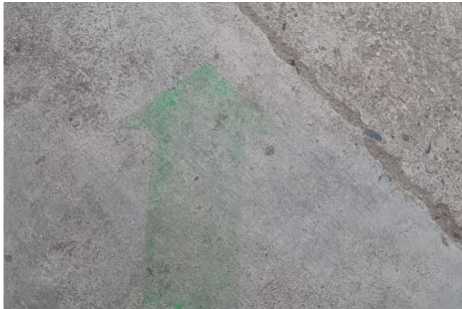
Figura 16 Señales de emergencia inadecuada
