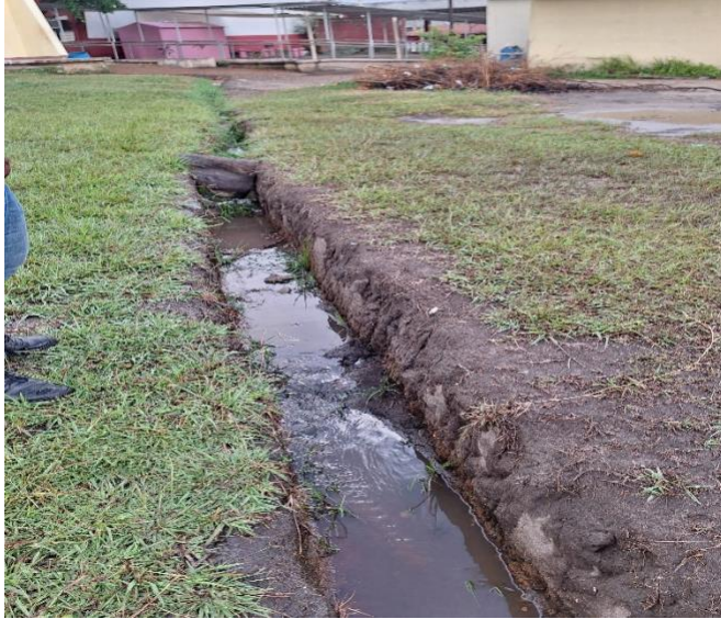
Figura 8 Zanja de agua
