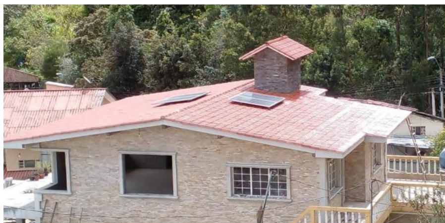
Ilustración 6. Casa de estudio con el sistema fotovoltaico instalado.
