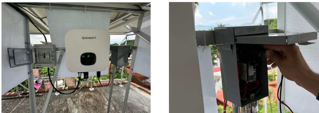
Ilustración 26: Inversor y protección en CA.
