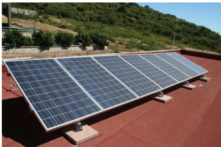
Ilustración 4: Sistema fotovoltaico instalado.
