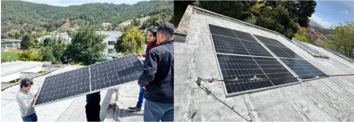
Figura 15. Ubicación de los paneles solares en el edificio Simón Bolívar
