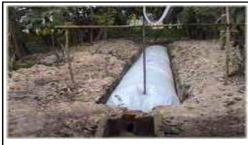
FIG 4: Biodigestores de estructura flexible
