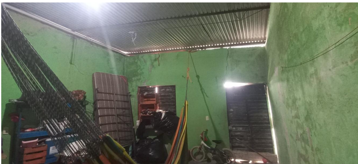
Figura 84. Cuarto de una vivienda con asentamientos, cuarteaduras y puerta inclinada ubicada en la esquina de la calle Villa Loma y Boulevard Loma Bonita (Foto: Lucero Jiménez, 2024).
