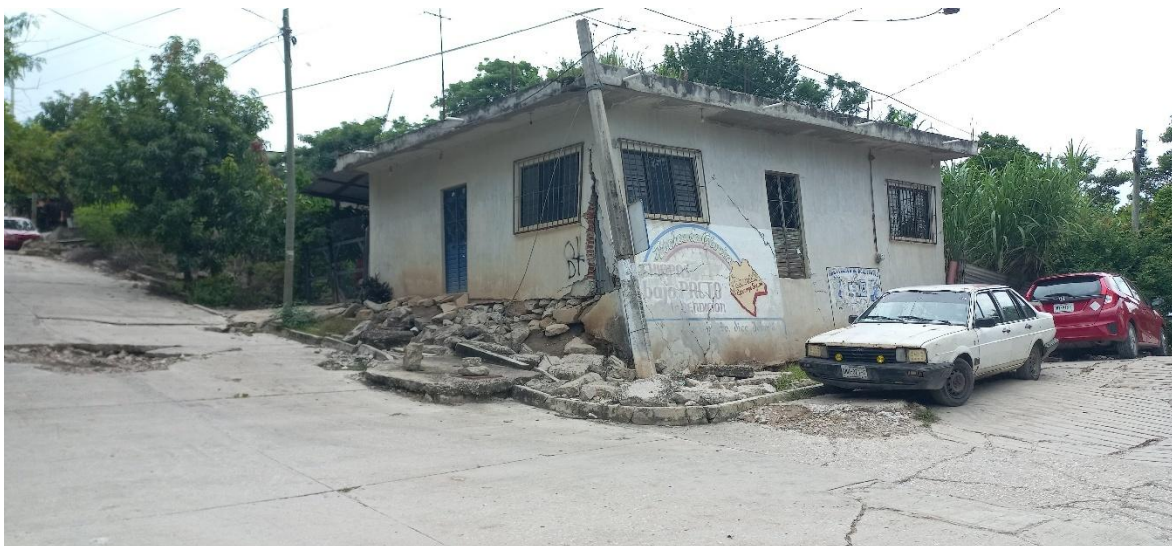
Figura 74. Vivienda con severos daños sobre la calle Lomas del Encanto (Foto: Lucero Jiménez).
