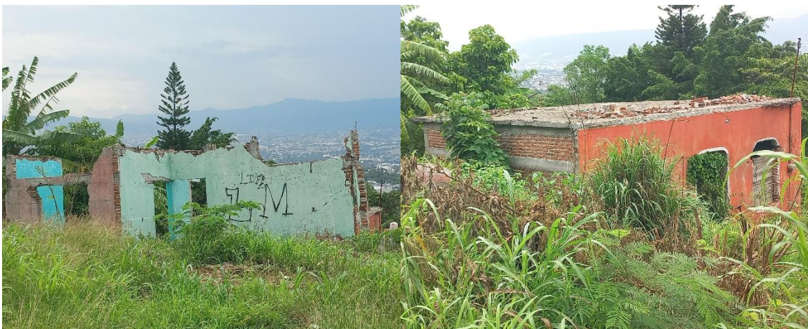
Figura 85. Viviendas con partes demolidas y abandonadas en Avenida Loma Linda (Foto: Lucero Jiménez, 2024).
