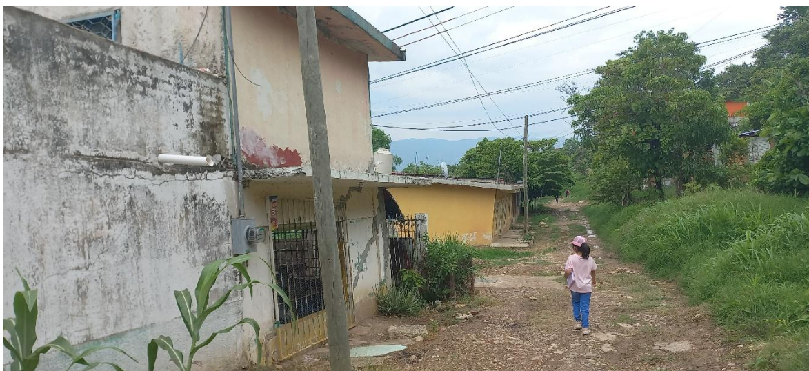
Figura 73. Vivienda con afectaciones, casa amarilla con hundimientos, sobre la Avenida Lomas del Pedregal (Foto: Lucero Jiménez).
