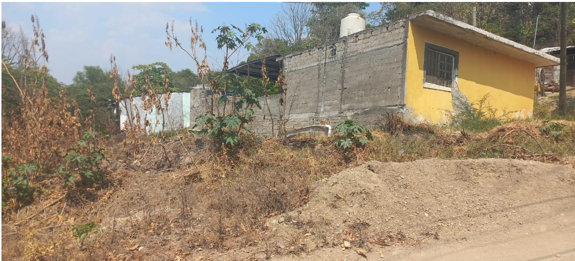
Figura 69. Vivienda que presenta grietas y hundimientos en calle Lomas del Pedregal (2025).
