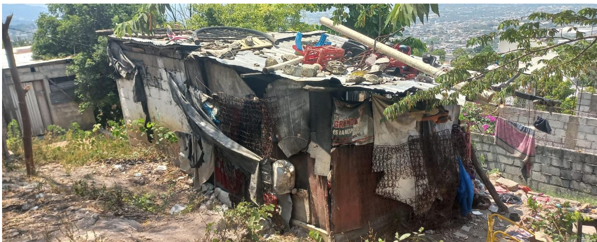
Figura 88. Vivienda en calle Suspiro, con materiales precarios (Foto: Lucero Jiménez, 2025).
