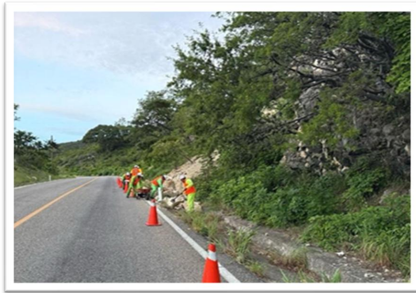
Imagen 21. Remoción de material derivada de escurrimiento del terreno.
