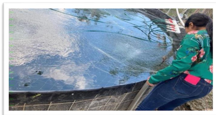
Figura 22. Estanque de geomembrana instalada.
