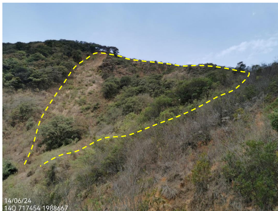
Figura 20. Deslizamiento rotacional en paraje simple 109 de localidad XXV. Montañas tectónicas en clima semicálido subhúmedo.
