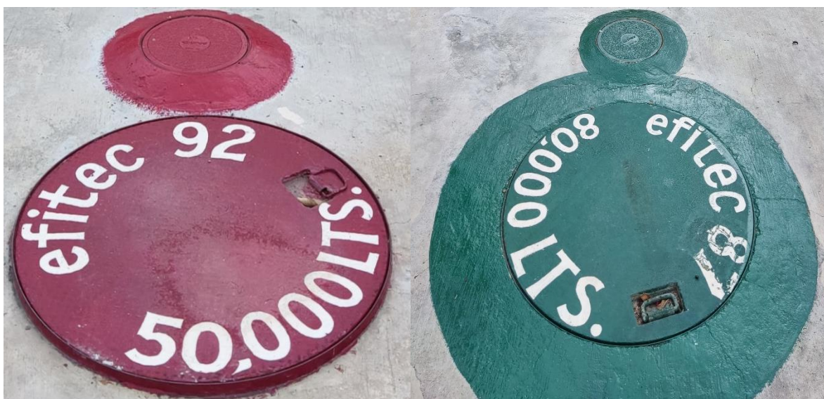
Ilustración 16 Tanques de almacenamiento de la gasolinera “La Diana” Tomada de: Fuente propia
