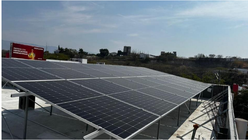
Figura 42. Sistema fotovoltaico completamente instalado.
