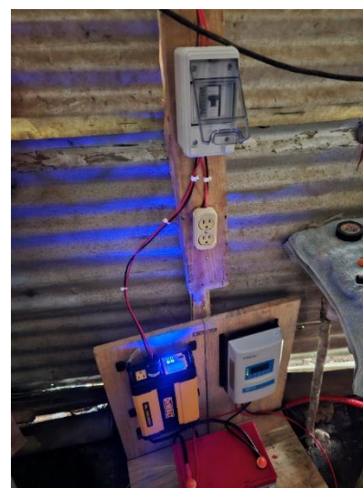
Imagen 60. Conexión de la clavija del inversor al centro de carga. Imagen por: Mario Benitez.
