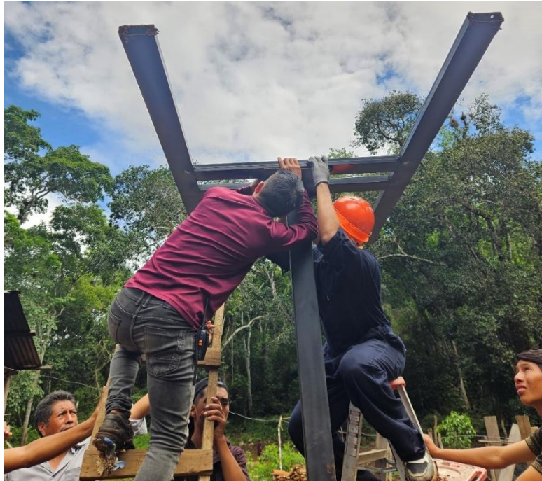
Imagen 35. Colocación de la estructura en forma de H. Imagen por: Óscar Martínez.
