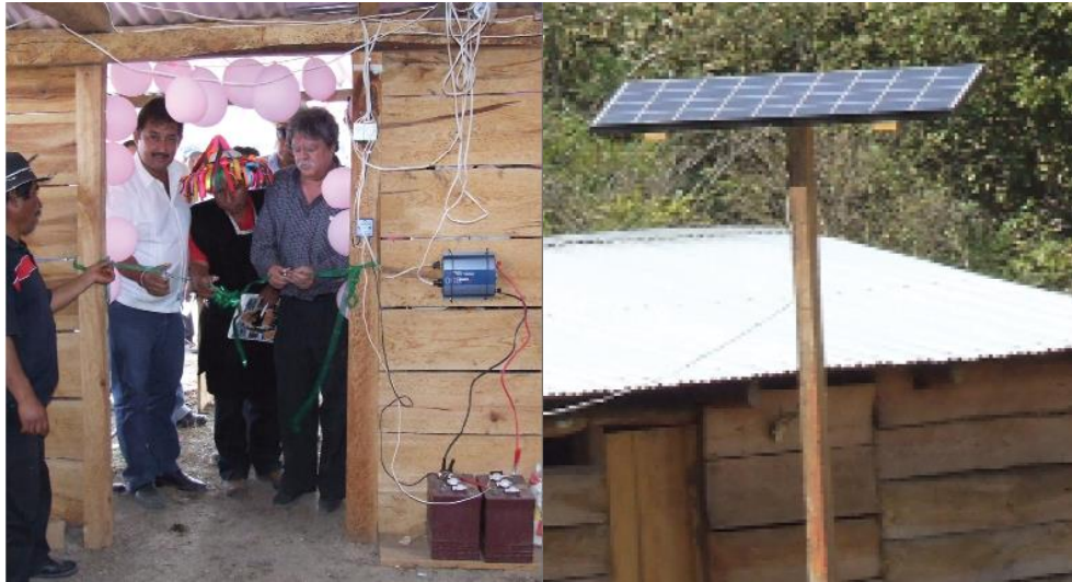
Imagen 2. Instalación fotovoltaica en Monte Horeb.
