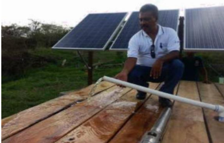
Imagen 5. Sistema de bombeo autónomo implementado en Nuevo Amanecer Tenejapa, Cintalapa, Chiapas.
