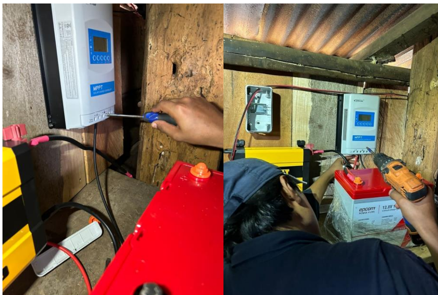
Imagen 47. Conexión positiva y negativa de la batería al controlador de carga. Imagen por: Williams Morgan.
