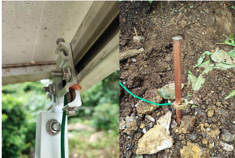
Imagen 51. Conexión de la protección de tierra del SF. Imagen por: Mario Benitez.
