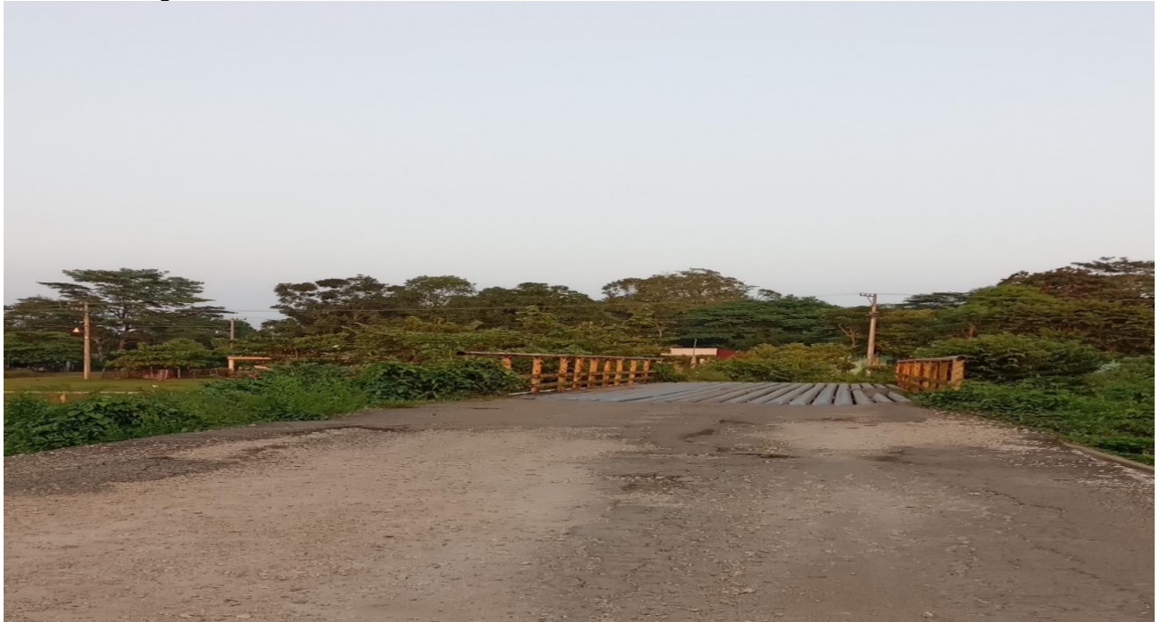
Figura 15. Punto de Riesgo 1
