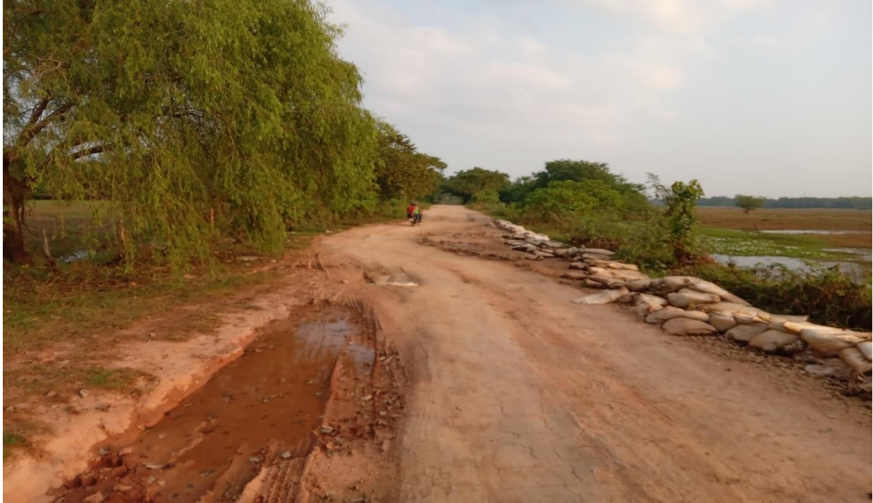
Figura 21. Punto de Riesgo 7
