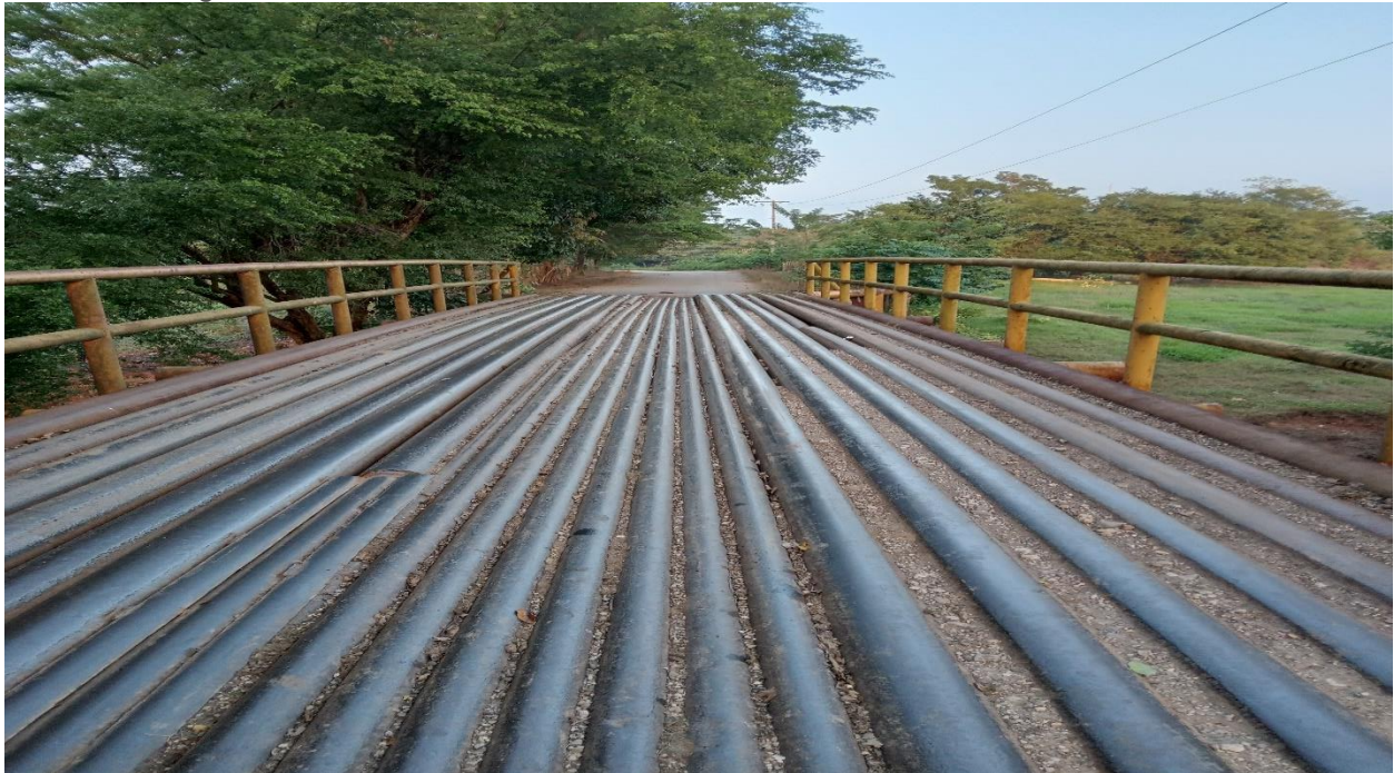
Figura 16. Punto de Riesgo 2
