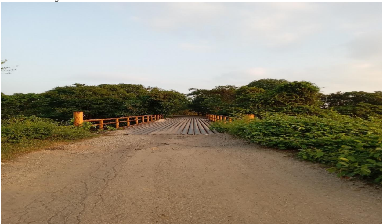
Figura 18. Punto de Riesgo 4
