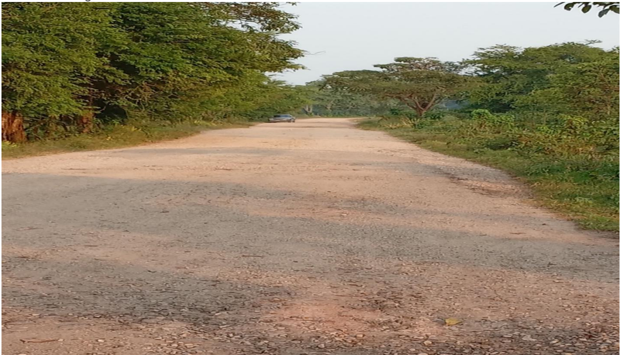
Figura 22. Punto de Riesgo 8
