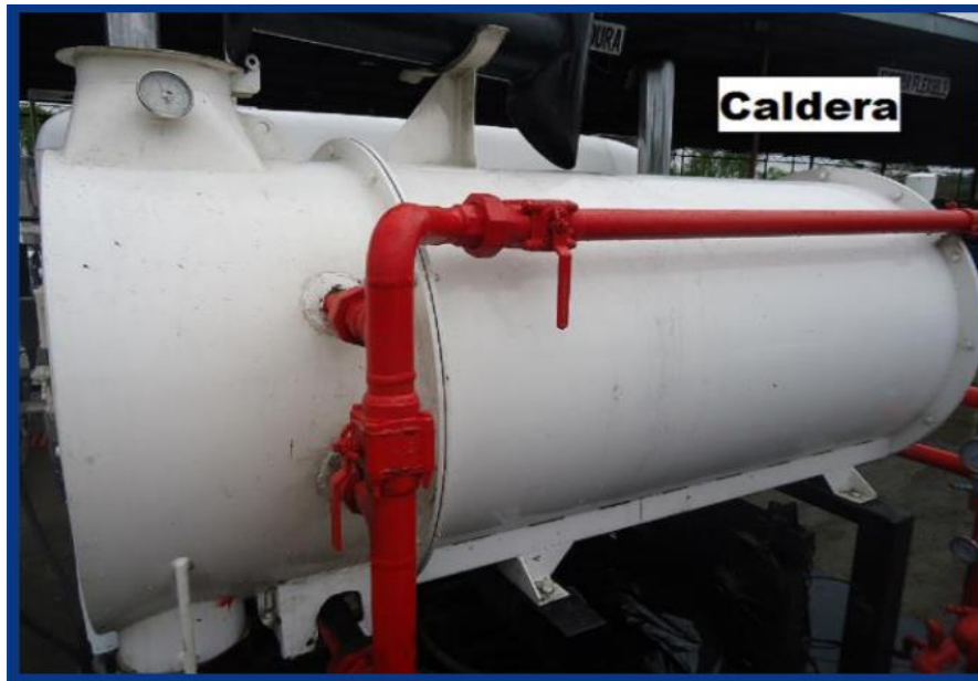
Ilustración 9 Unidad de Aceite Caliente - Caldera.
