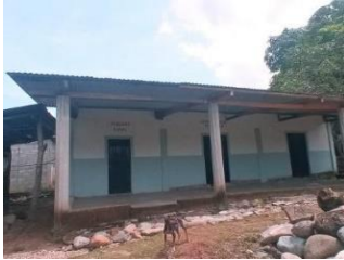
Imagen 2, ubicación del captador de agua pluvial.
