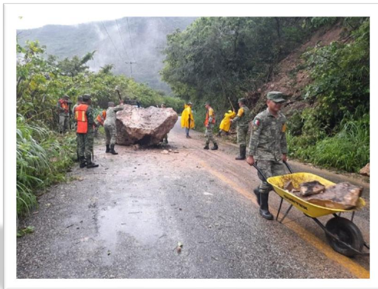
Figura 14. Deslizamientos en Acapetahua, Escuintla, Tapachula y Catazajá. Fuente: Torres (2023).
