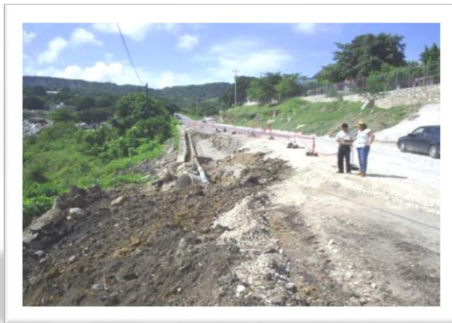
Figura 4. Deslizamiento rotacional en la carretera Tuxtla Gutiérrez - Villaflores. Fuente: Paz (2012).
