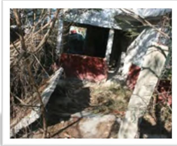
Figura 3. Viviendas deterioradas en la colonia La Cueva del Jaguar. Fuente: CECOM A.C. (2010).
