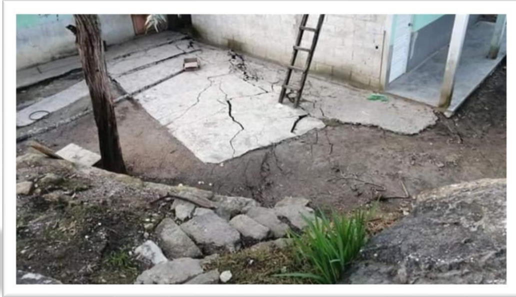
Figura 10. Afectación en las viviendas de la localidad Matzam, municipio de Tenejapa. Fuente: Pascacio (2020).
