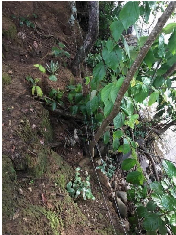
Figura 4 Alambrado roto por degradación del suelo.
