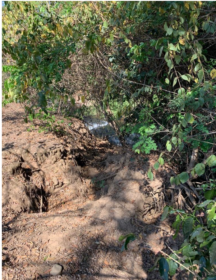
Imagen. - 10 Se observa cual fue el deslizamiento presentado en el rancho San Gabriel, se evidencia la presencia de huecos y desgaste de suelo, ha generado la inestabilidad necesaria para que el suelo se erosionara. Fuente: Tomada de Zonas identificadas [fotografía], (Hernández 2021).
