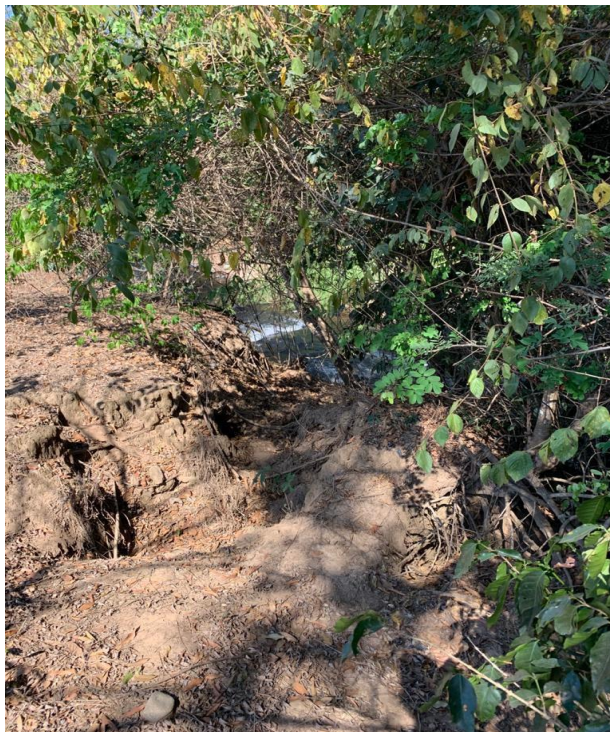
Imagen. - 13 Se observa hasta dónde llega el agua del río, que es un proceso degenerativo.
