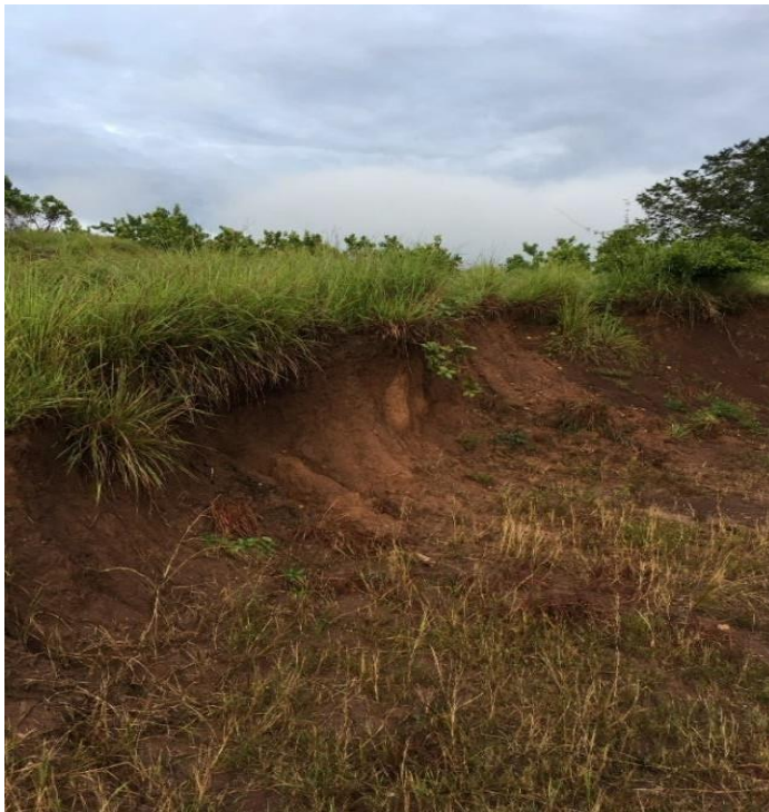
Imagen. - 15 Se observa la gran cantidad de degradación por la gran apertura del río limón que incrementa entemporada de lluvia.
