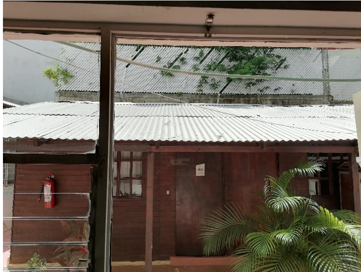
Figura 9. Problema de deslumbramiento causado por reflexión de una lámina. Fuente Propia (2021).
