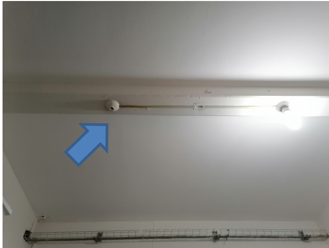
Figura 8. Ausencia de una de las luminarias en Archivo de Impacto Ambiental. Fuente Propia (2021).
