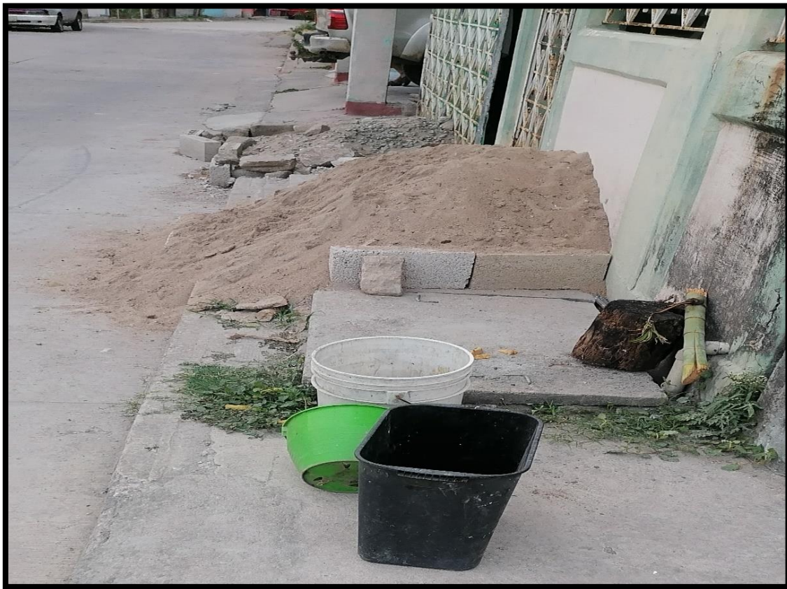
Figura 10. Obstrucción de banquetas por materiales de construcción
