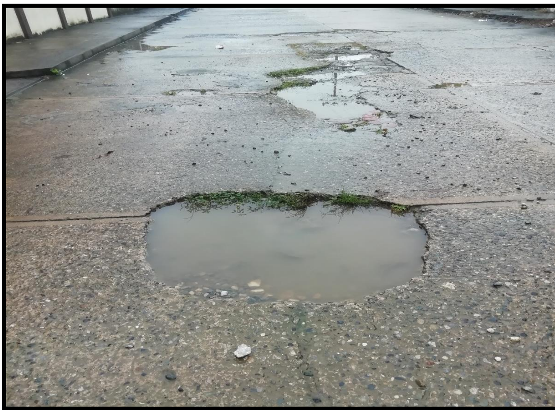
Figura 8. Calles en mal estado
