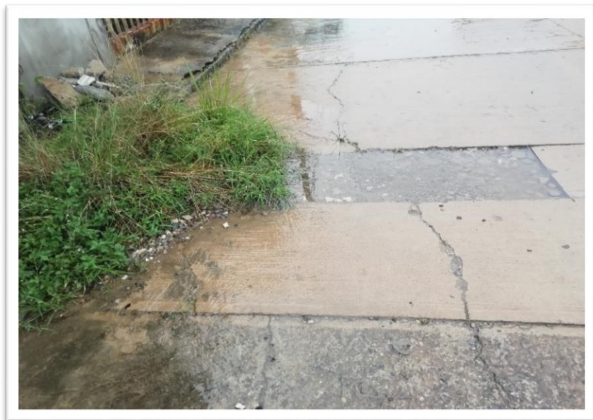
Figura 14. Calles y banquetas incompletas
