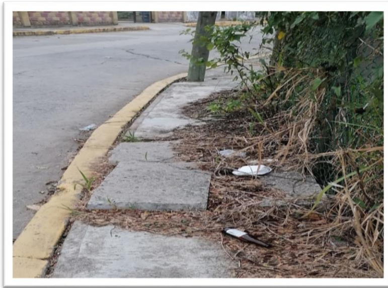
Figura 18. Banquetas rotas y obstruidas por monte
