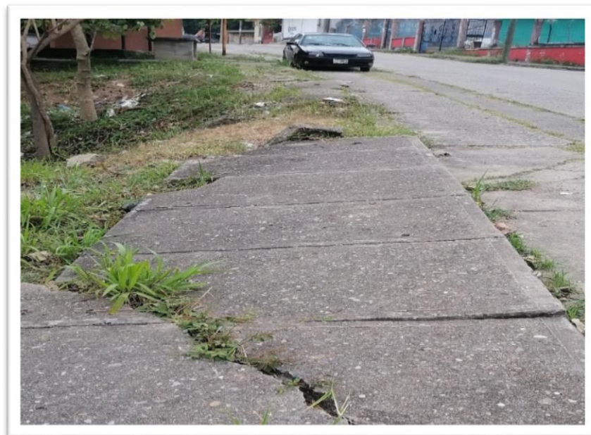
Figura 19. Banquetas incompletas por falta de mantenimiento
