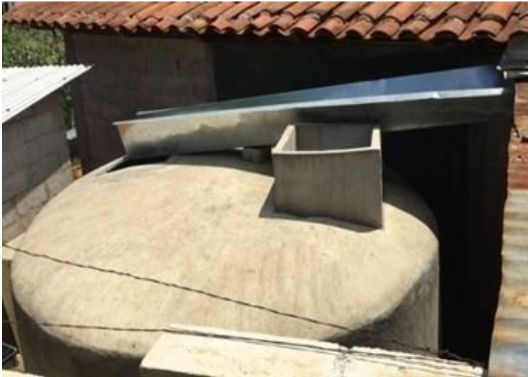
Fotografía 2. Tinaco de cemento
