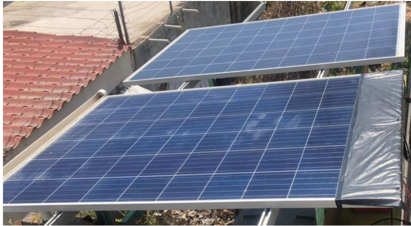
Ilustración 37. Módulo fotovoltaico con sombra en la línea horizontal superior de celdas.
