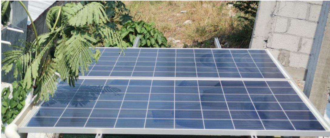
Ilustración 43. Módulo Fotovoltaico con la sombra de una rama.
