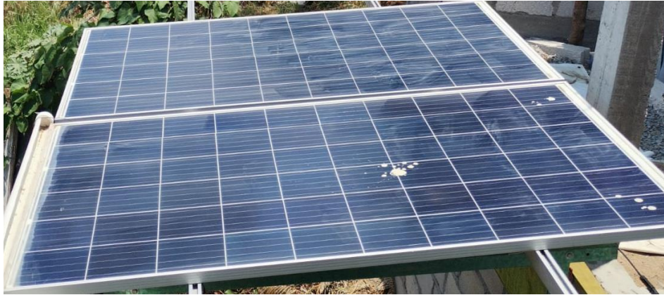
Ilustración 42. Módulo Fotovoltaico con la sombra del excremento de aves.
