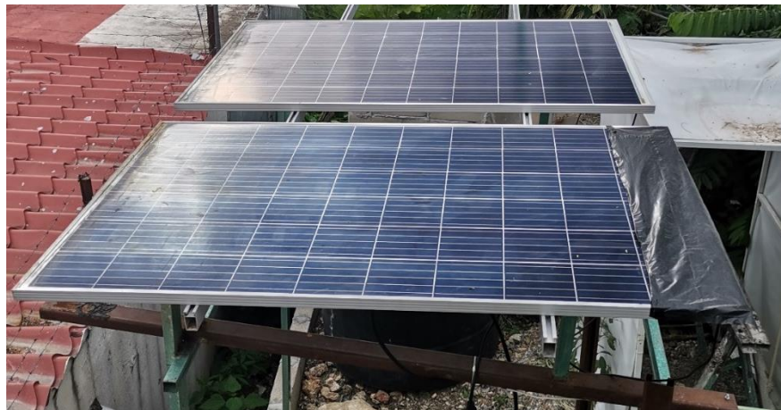
Ilustración 46. Sistema fotovoltaico interconectado a red con una sombra en la línea superior de celdas de uno de los módulos del sistema.
