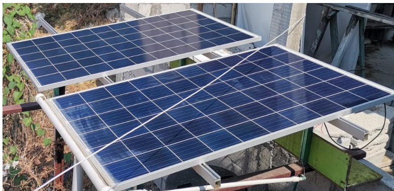
Ilustración 39. Módulo Fotovoltaico con sombra de un cable.
