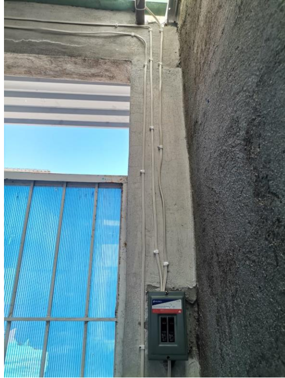
Ilustración 57. Conexión eléctrica a la pastilla termomagnética y al centro de carga.
