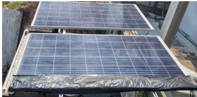
Ilustración 38. Módulo Fotovoltaico con sombra en la línea vertical de celdas del extremo izquierdo.
