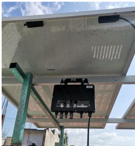
Ilustración 53. Microinversor instalado en la estructura metálica de los módulos.
