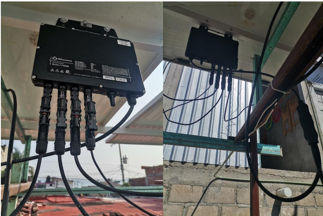
Ilustración 58. Conexión del microinversor a los módulos fotovoltaicos y a la red eléctrica.
