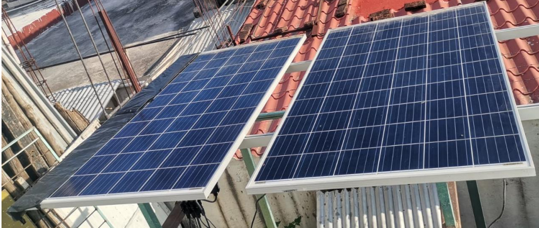
Ilustración 47. Sistema fotovoltaico interconectado a red con una sombra en la línea de celdas de forma vertical del extremo izquierdo de uno de los módulos del sistema.
