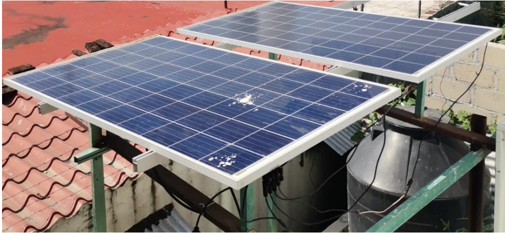
Ilustración 51. Sistema fotovoltaico interconectado a red con una sombra simulando excremento de aves sobre uno de los módulos del sistema.
