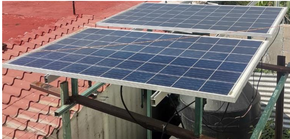
Ilustración 48. Sistema fotovoltaico interconectado a red con una sombra simulando un cable sobre uno de los módulos del sistema.
