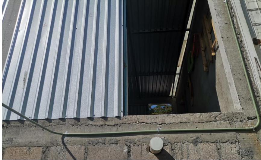
Ilustración 55. Tubo conduit instalado en la pared exterior del taller que se conectó al tubo instalado en la estructura metálica de los módulos.
