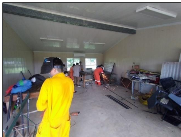
Figura 9: Condición Insegura. Falta de señalamientos (Fuente: Con base a la información obtenida)
