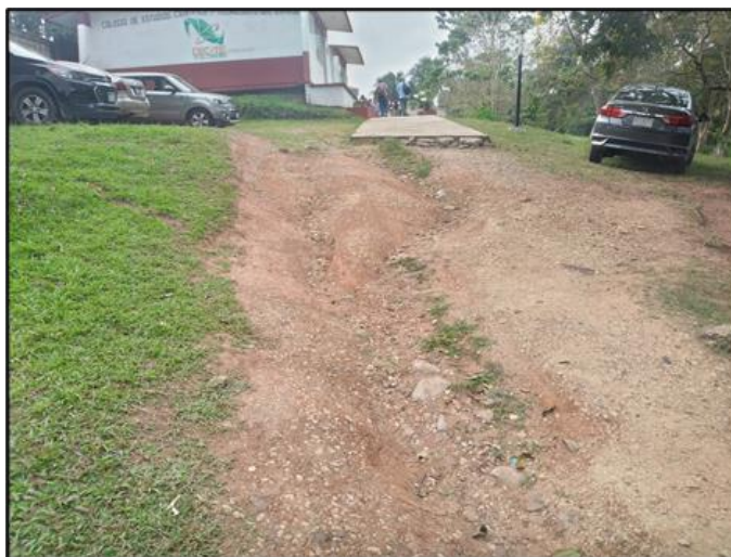
Figura 7: Condición Insegura. Entrada Principal. (Fuente: propia del autor)
