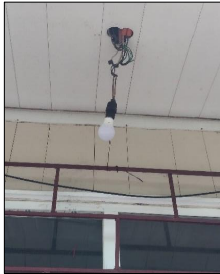
Figura 8: Cableados Eléctricos en Malas Condiciones. (Fuente: propia del autor)
