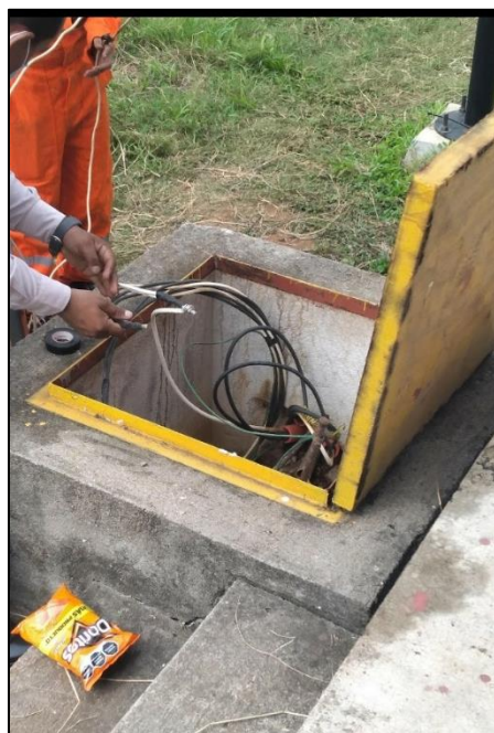
Figura 12: Condición Insegura. Registros. (Fuente: propia del autor)
