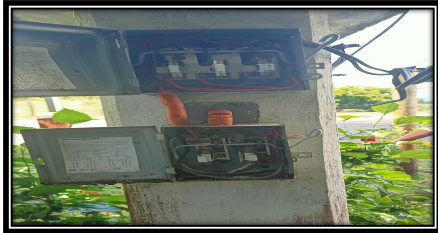
Figura 16 Tubería con cableado en muy mal estado. Fuente: Con base en la información obtenida.
