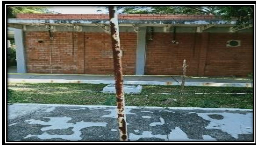
Figura 15 Tubería con cableado en muy mal estado. Fuente: Con base en la información obtenida.
