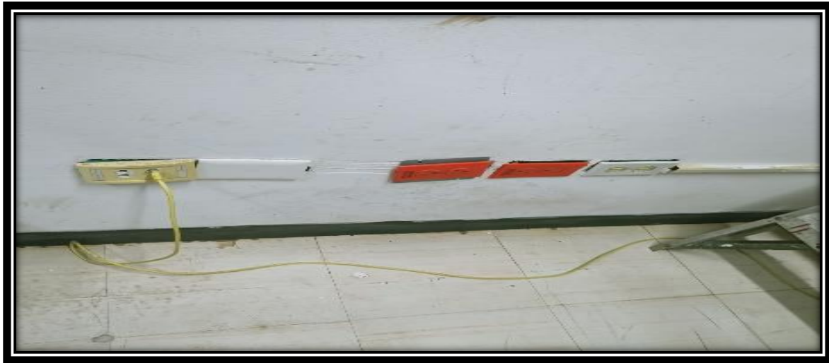
Figura 18 Instalación demasiada saturada de enchufes. Fuente: Con base en la información obtenida.
