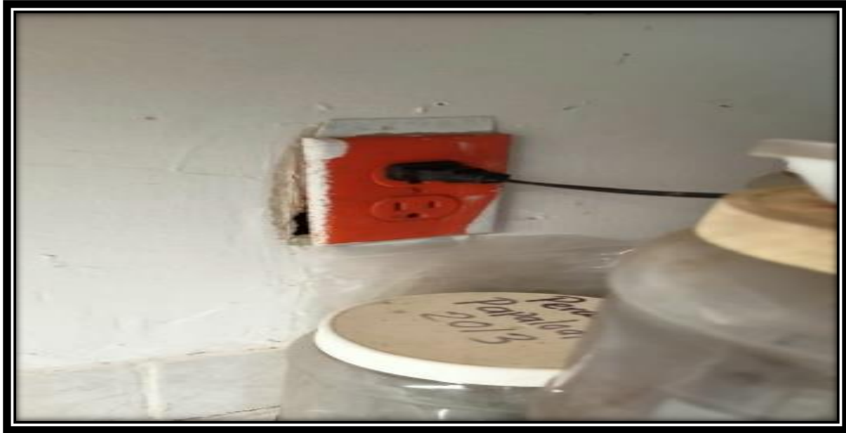
Figura 10 Enchufes eléctricos cerca de los lavabos y en mal estado. Fuente: Con base en la información obtenida.
