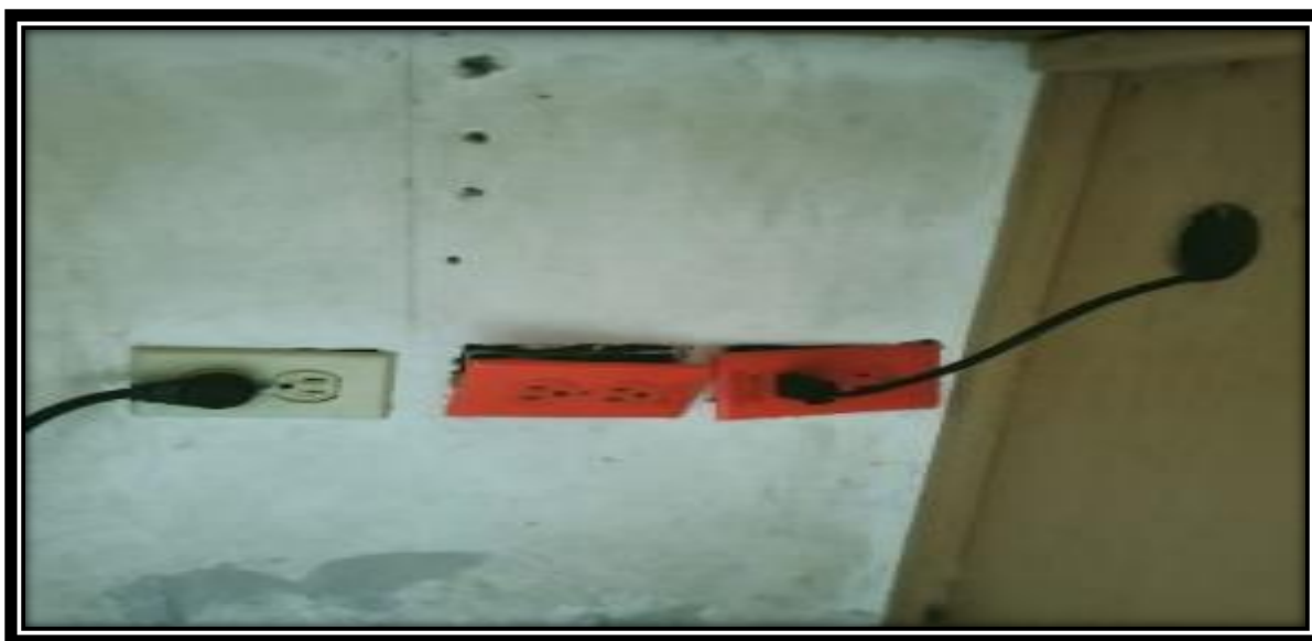
Figura 11 Clavijas salidas y en mal estado. Fuente: Con base en la información obtenida.
