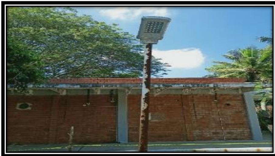
Figura 13 Lámparas sin capucha y en mal estado. Fuente: Con base en la información obtenida.
