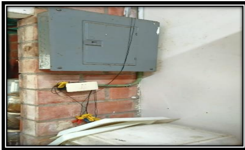
Figura 9 Objetos que cuelgan y amarran en una instalación eléctrica. Fuente: Con base en la información obtenida
