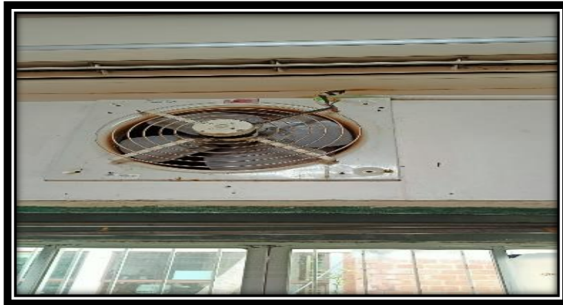
Figura 8 Cableado del extractor de aire del laboratorio sin el correcto aislamiento. Fuente: Con base en la información obtenida
