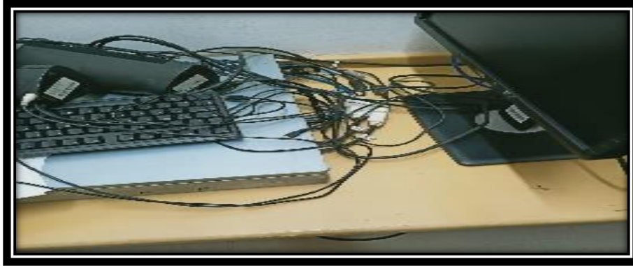
Figura 12 Cableado en los servidores muy amontonados. Fuente: Con base en la información obtenida.
