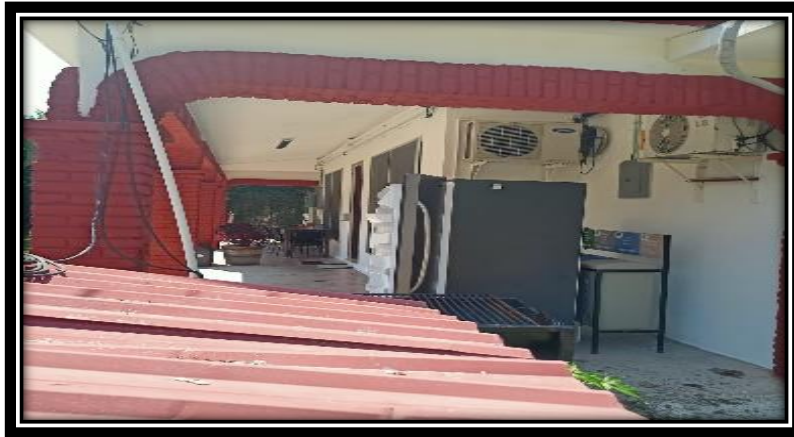
Figura 6 Nidos de insectos tales como abejas y hormigas en la caja de fusibles
