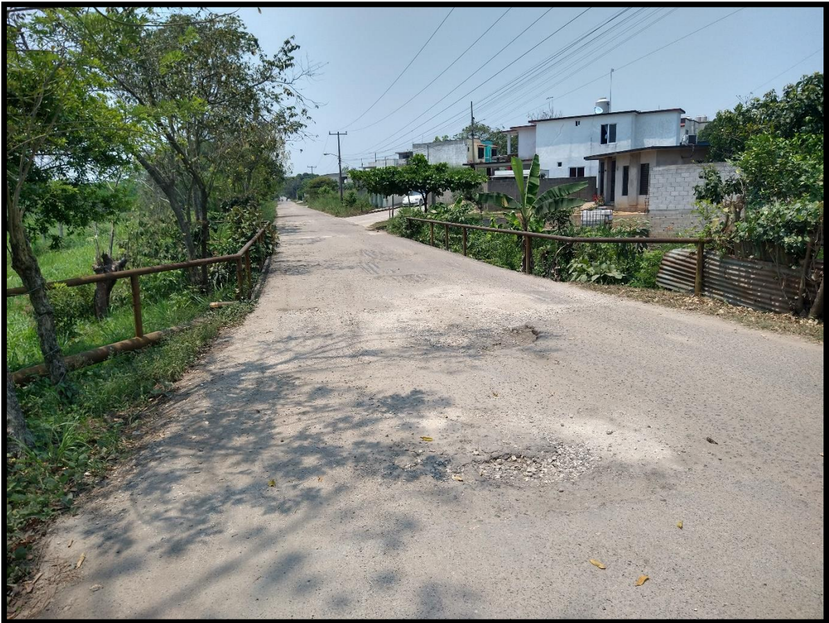
Figura 10. Puente en mal estado de la carretera.
