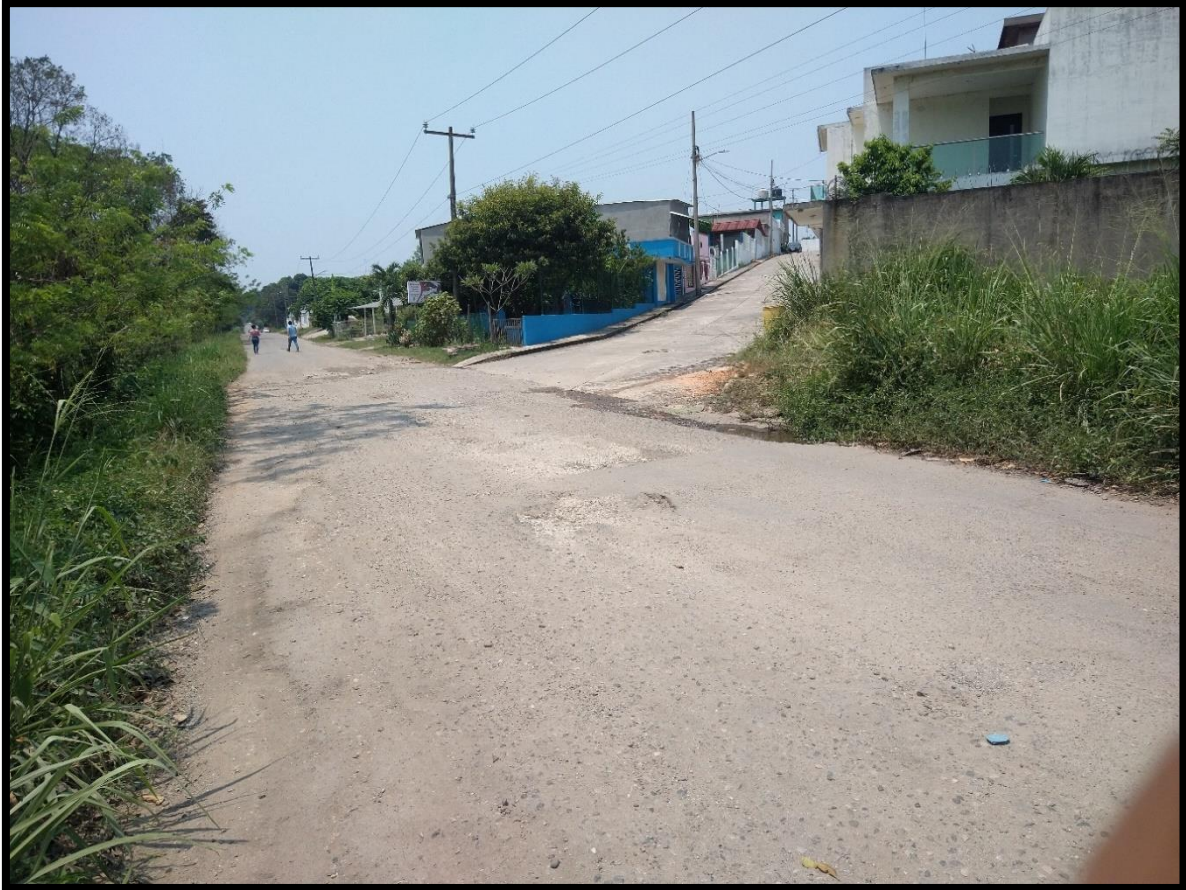
Figura 11. Falta de señalamientos.
