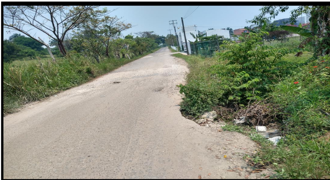
Figura 14. Deslave de la carretera Fuente. Con base a la información obtenida
