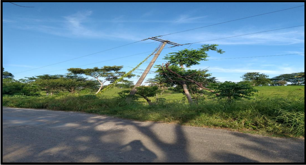
Figura 17. Poste de luz en mal estado Fuente. Con base a la información obtenida
