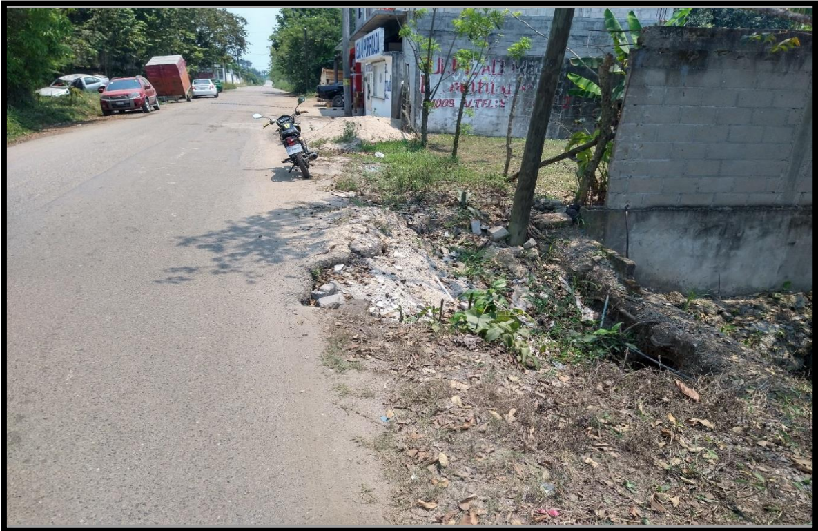
Figura 6. Hundimiento de la carretera a la planta de lodo.
