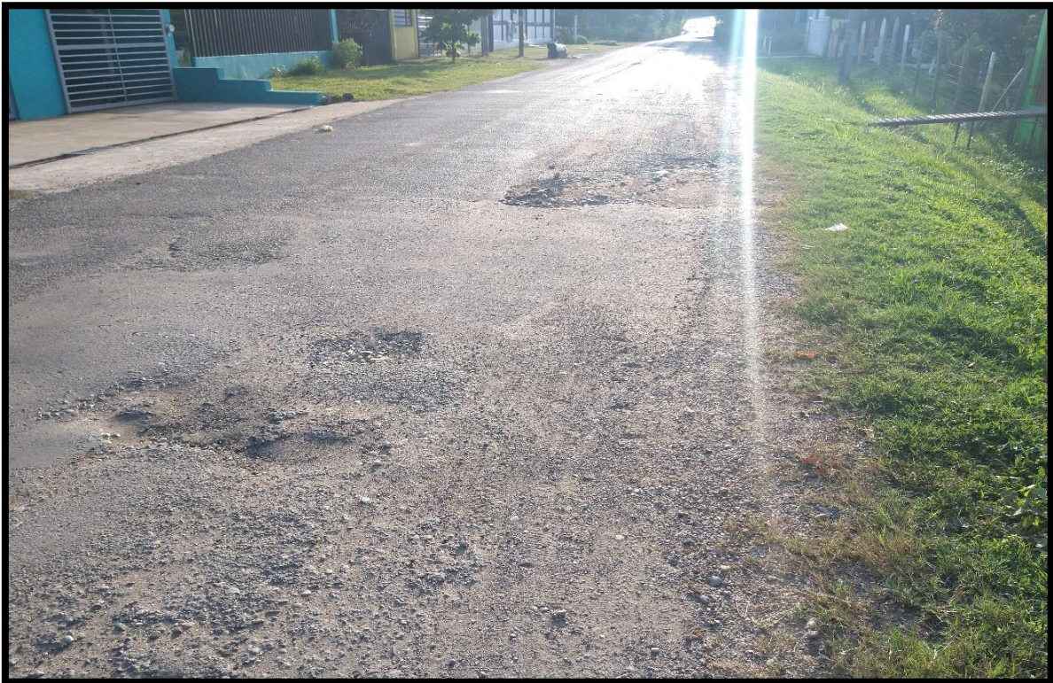
Figura 5. Baches en la carretera a la planta de lodo.
