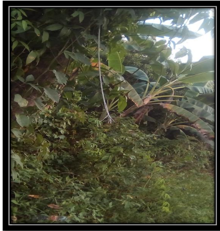
Imagen 7. Desprendimientos De Cables En Los Postes De Luz Fuente: En Base A La Información Obtenida
