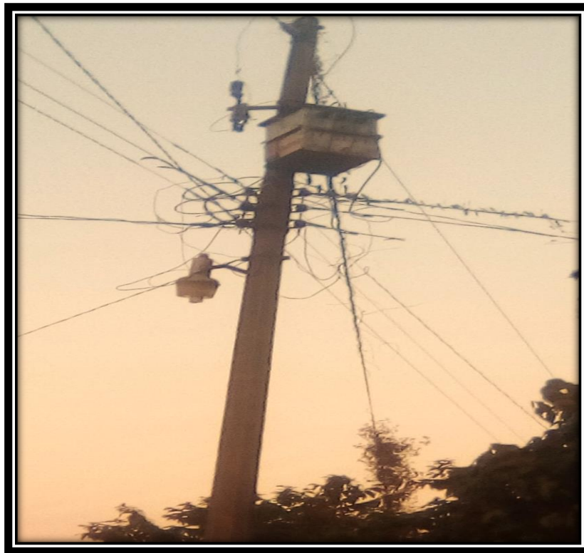
Imagen 9. Cables En Postes De Luz Enredados
