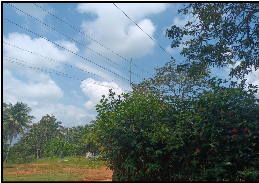
Imagen 17. cables con separadores
