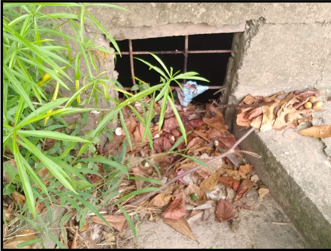
Figura 10. Dren con acumulación de hojas
