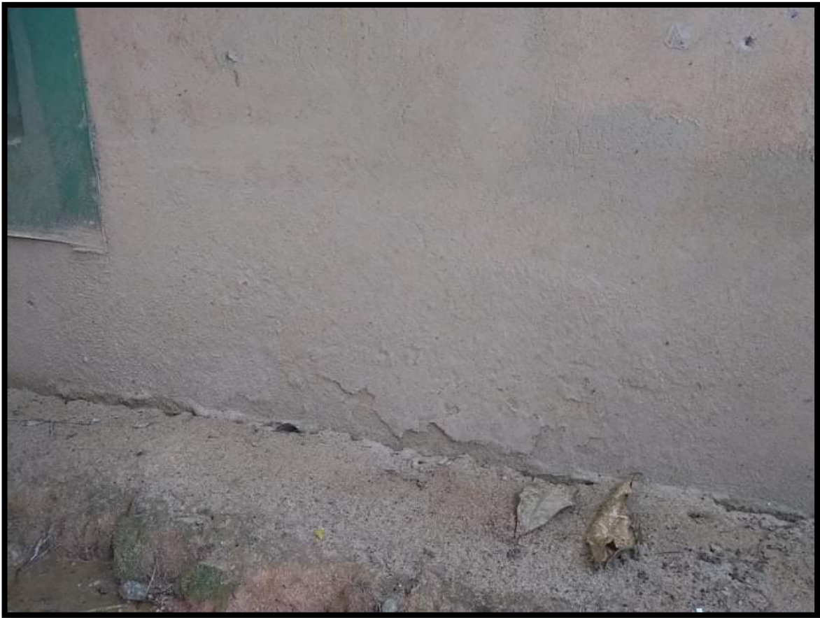
Figura 6. Hundimiento de vivienda por humectación del suelo
