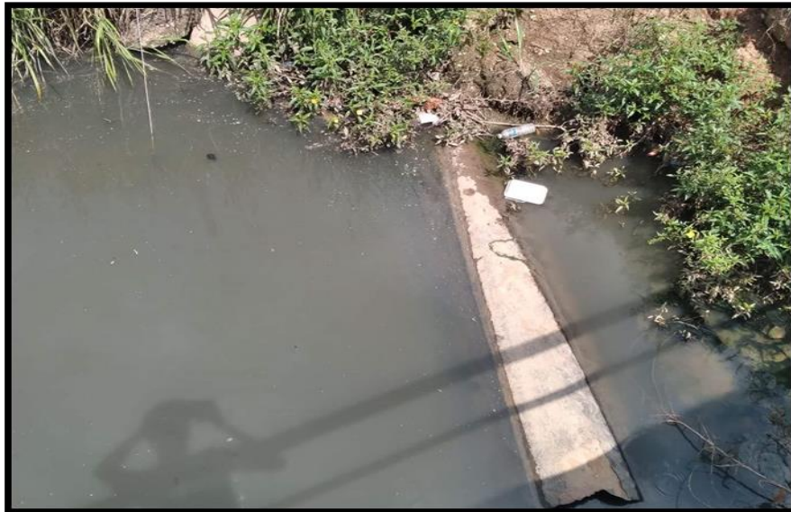
Figura 18. Basura en arroyo que provoca que se tapen las alcantarillas
