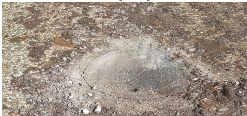
FIGURA 22: Pozo de visita 8. Sellado a un 70%.
