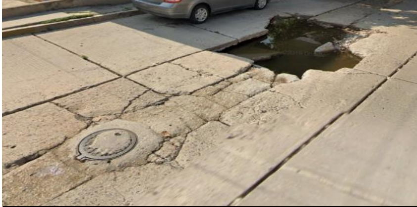
FIGURA 20: Pozo de visita 6. socavón de aguas negras.
