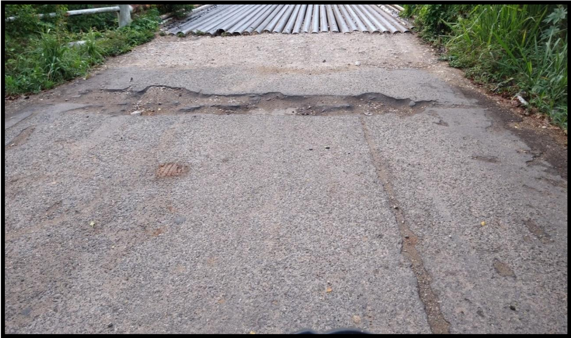
Figura No 20. Zanja En La Carretera
