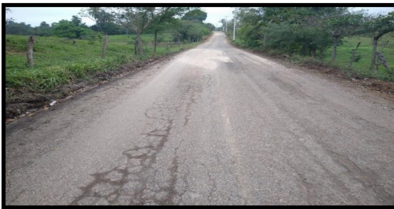
Figura No 14. Describir El Estado Físico En Que Se Encuentra El Tramo Carretero R/A Ignacio Zaragoza A R/A El Trapiche
