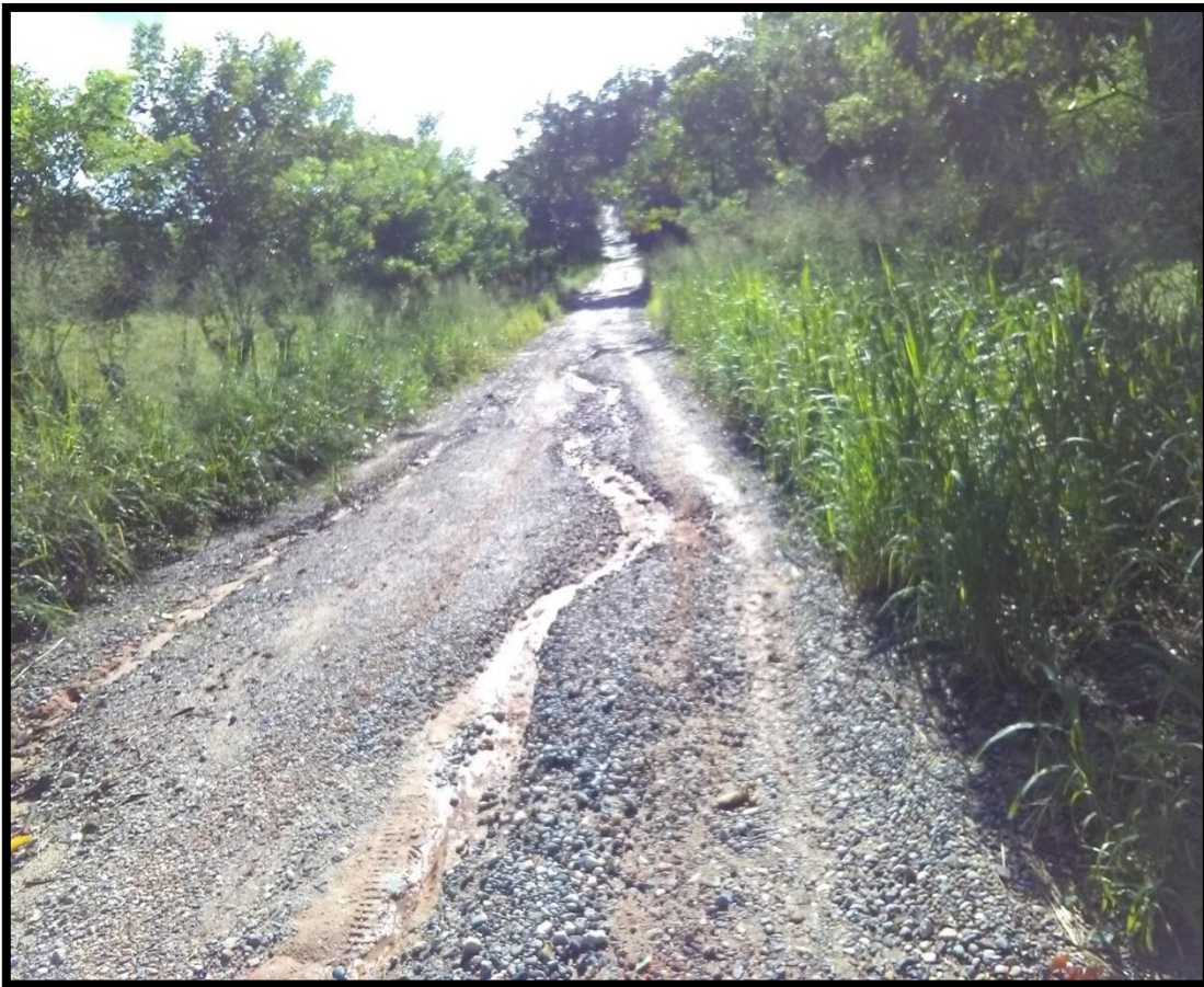
Figura No 21. Grietas En La Carretera
