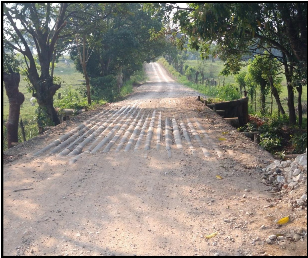
Figura No 17. Puente Sin Barandal
